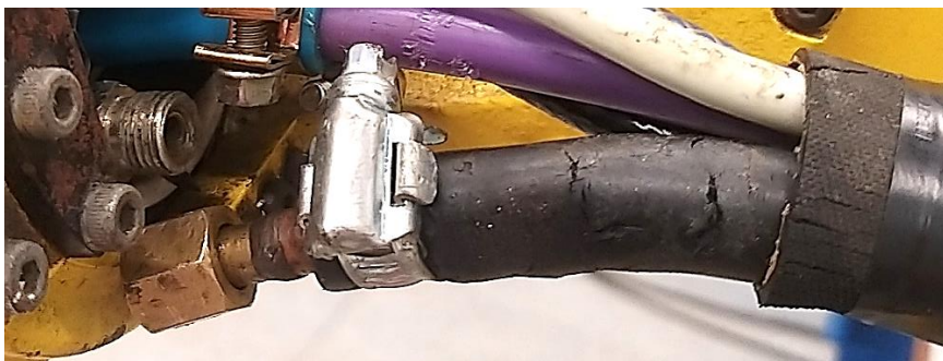
Figura 13 – Cabo de força com rachaduras
