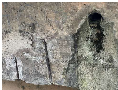
Foto 6- Eflorescência na saída da drenagem.
