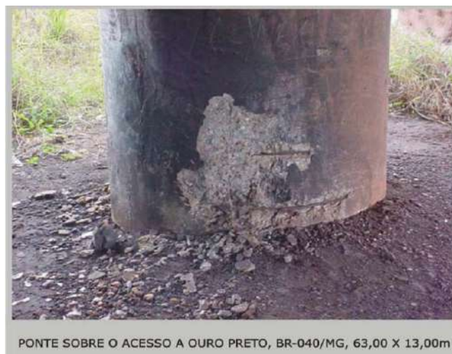
Figura 7 - Destacamento de revestimento em pilar de ponte. Fonte: Brasil (2004).
