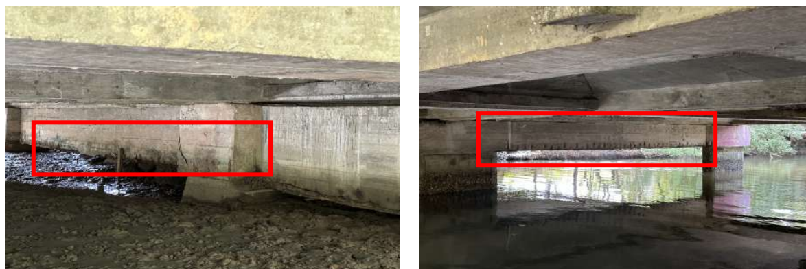
Figura 27 - Deslocamento do concreto e corrosão de armaduras nas transversinas da ponte da Av. da Saudade. Fonte: Própria (2023).
