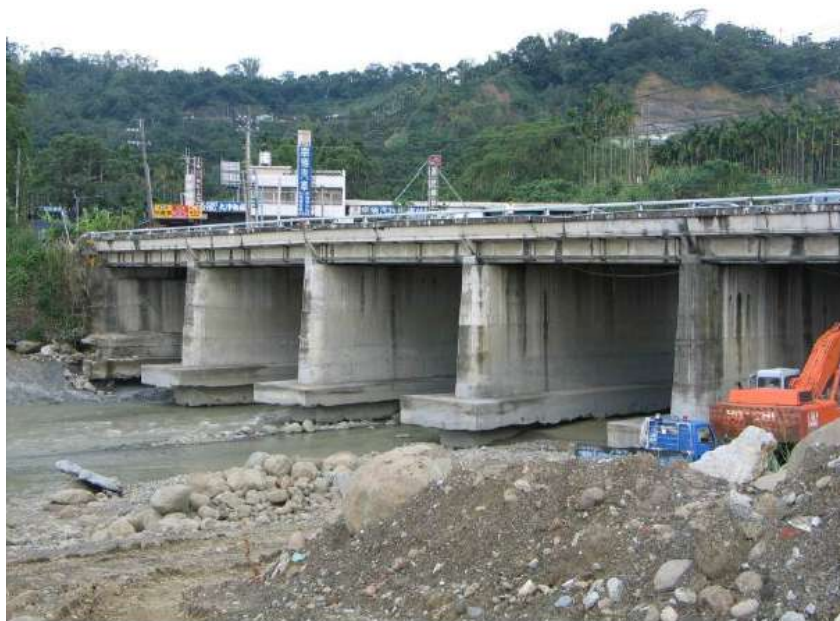
Figura 9 - Fundações de ponte erodidas pela ação da água. Fonte: Tejedor (2013).
