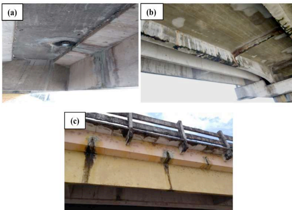
Figura 2 - Bolor na saída das canalizações (a), em conjunto com eflorescência nas longarinas centrais (b) e nas de periferia (c). Fonte: Marques et al. (2018).
