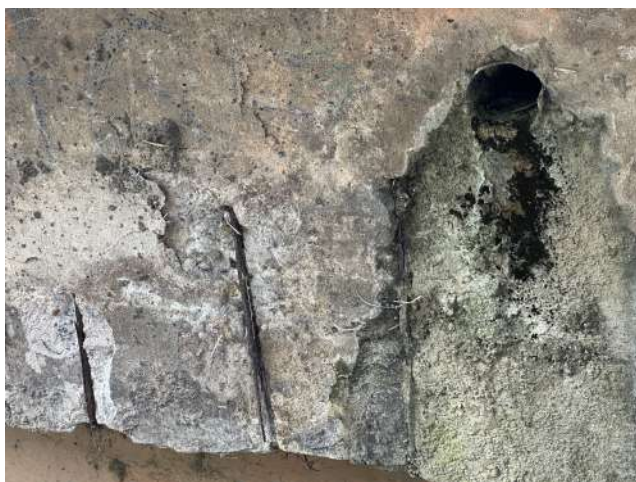
Figura 31 – Mofa/bolor e eflorescências no tabuleiro da ponte sobre o Rio Tavares. Fonte: Própria (2023).
