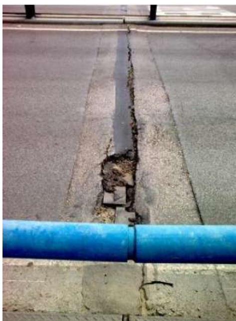
Figura 8 - Elevação da junta devido à dilatação. Fonte: Tejedor (2013).
