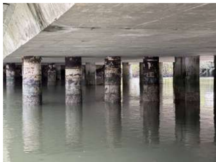
Foto 3 - Lixiviação da base dos pilares.
