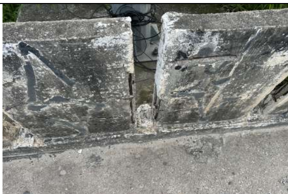
Foto 8 – Deslocamento e corrosão no guarda-corpo.
