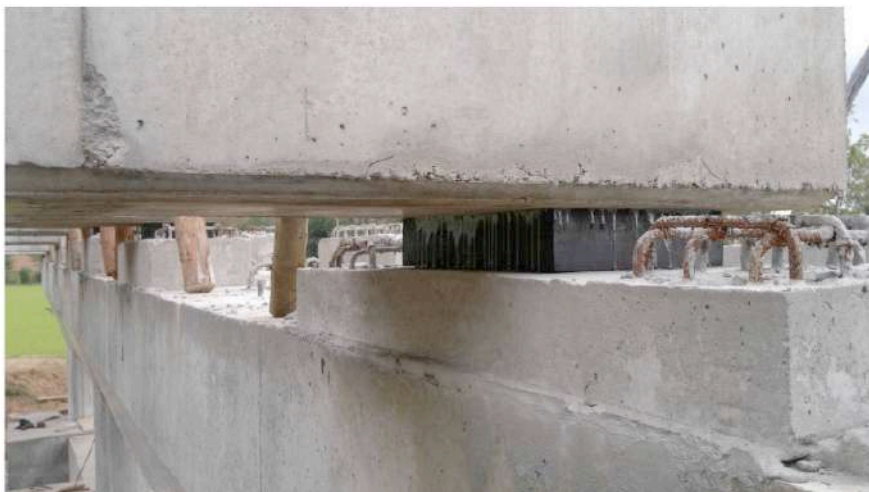
Figura 16 – Aparelho de apoio em ponte. Fonte: Nuernberg e Silva (2013).
