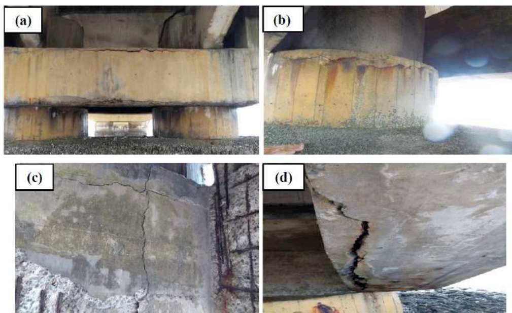
Figura 4 - Fissuras na parte frontal da travessa (a), no pilar (b), na parte interior (c) e inferior da travessa (d). Fonte: Marques et al. (2018).
