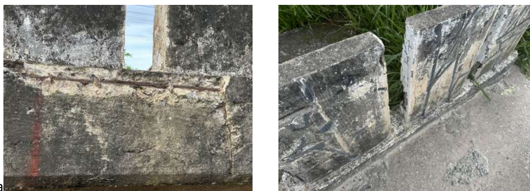
Figura 32 - Deslocamento de concreto no tabuleiro e nos guarda corpos da ponte sobre o Rio Tavares. Fonte: Própria (2023).
