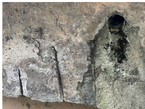
Foto 2 – Corrosão no tabuleiro.
