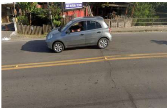
Foto 1 - Fissuras no pavimento.
