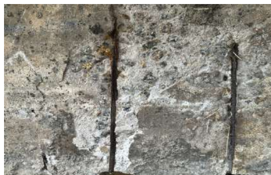
Foto 4 – Corrosão no tabuleiro.
