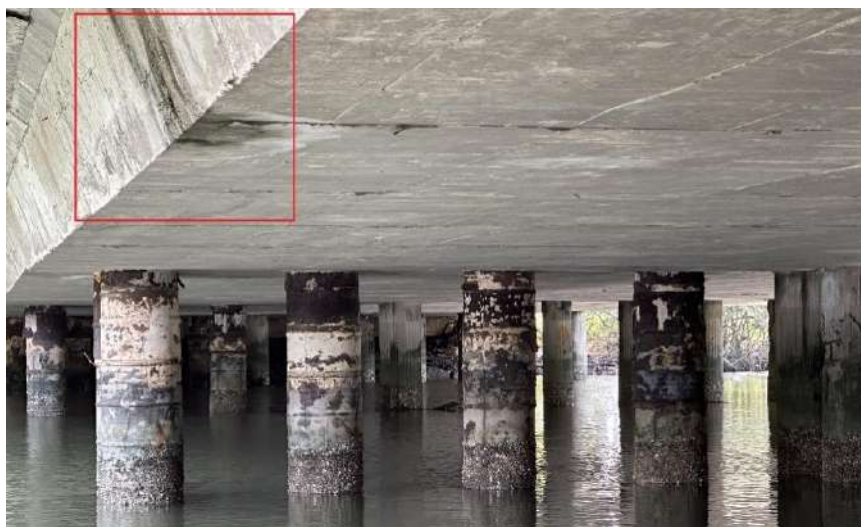
Figura 26 – Mofo/bolor na ponte da Av. da Saudade. Fonte: Própria (2023).
