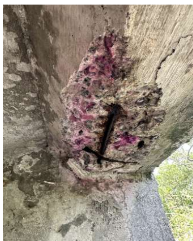
Foto 6- Corrosão de armaduras na superestrutura.
