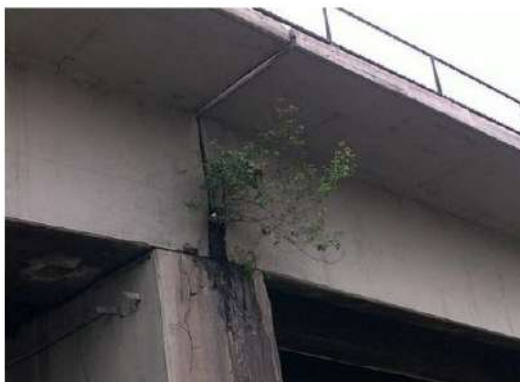
Figura 1 - Manchamento com enraizamento de árvore no tabuleiro de ponte Fonte: Tejedor (2013)
