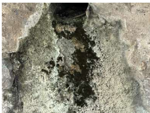
Foto 5 – Bofo/bolor na saída da drenagem.
