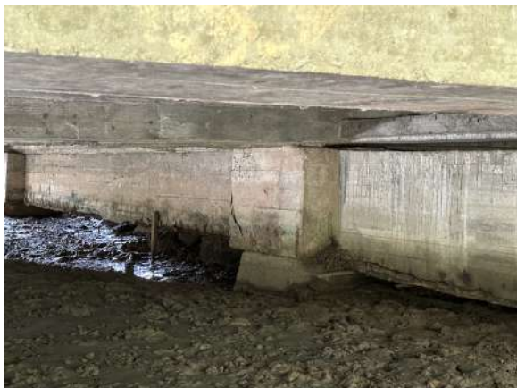
Foto 7 - Deslocamento do concreto e corrosão de armaduras nas transversinas.
