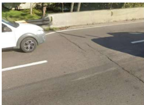
Foto 1 - Fissuras no pavimento.
