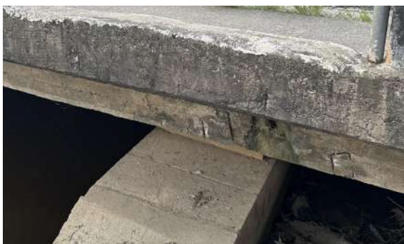
Foto 3 – Corrosão no tabuleiro da ponte, próximo ao apoio.
