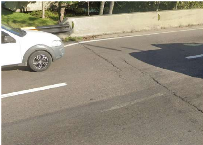
Figura 23 - Fissuração no pavimento da ponte da Av. da Saudade. Fonte: Própria (2023).
