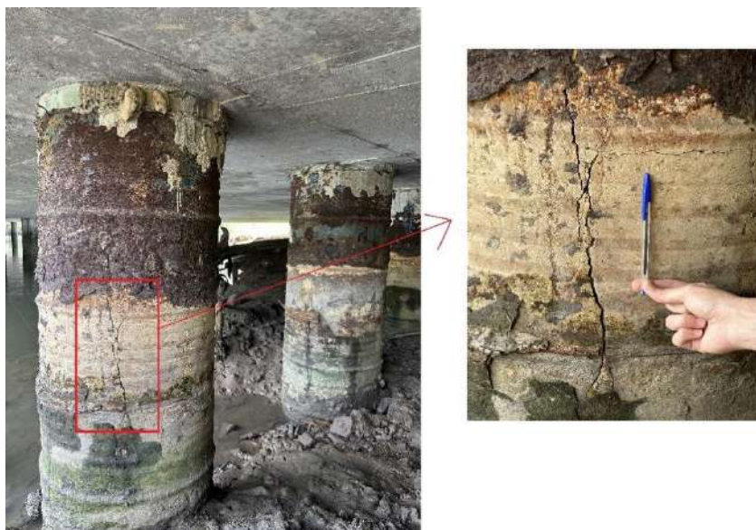
Figura 24 – Trinca em pilares da ponte da Av. da Saudade. Fonte: Própria (2023).
