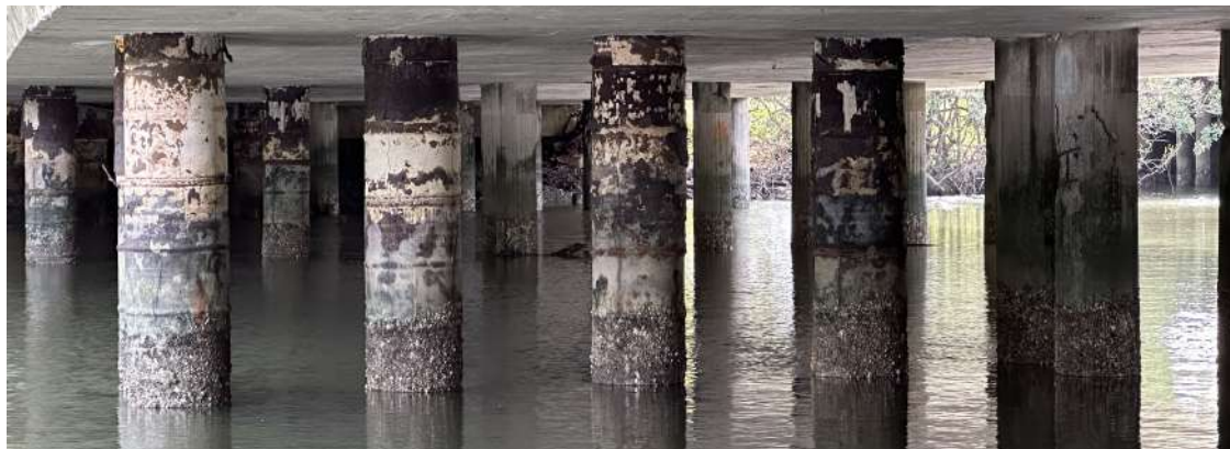
Figura 25 – Lixiviação da base dos pilares da ponte da Av. da Saudade. Fonte: Própria (2023).
