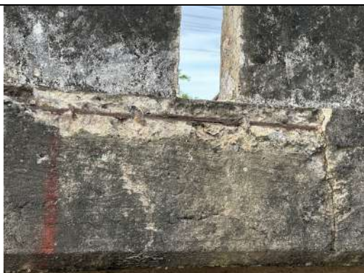
Foto 7 – Deslocamento do concreto e corrosão de armaduras no tabuleiro.
