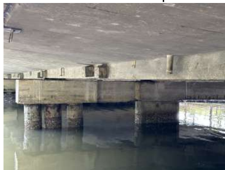
Foto 4 - Lixiviação nos pilares.
