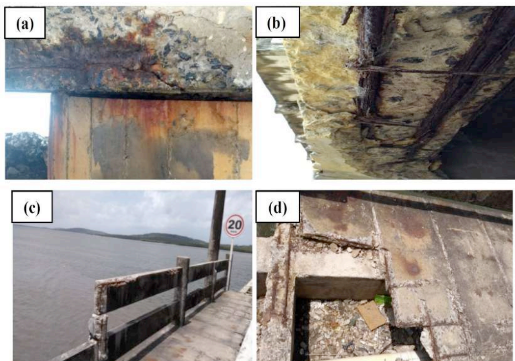
Figura 6 - Corrosão no encontro pilar/travessa (a), na travessa (b), colapso do guarda corpo (c) e passeio (d). Fonte: Marques et al. (2018).
