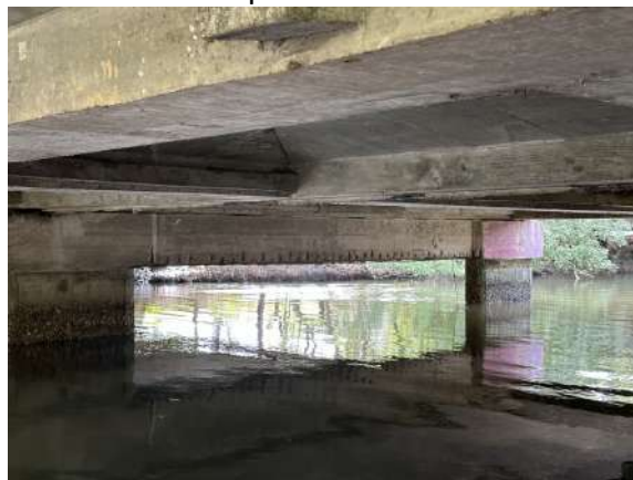
Foto 8 - Deslocamento do concreto nas transversinas.
