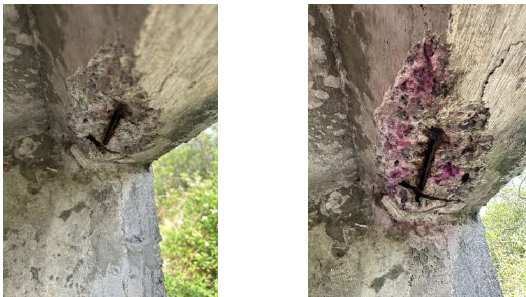
Figura 28 - Corrosão de armaduras nas transversinas da ponte da Av. da Saudade. Fonte: Própria (2023).
