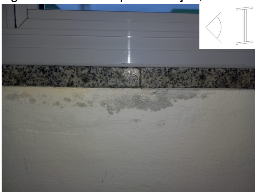
Figura 17: Umidade por infiltração, edifício 02
