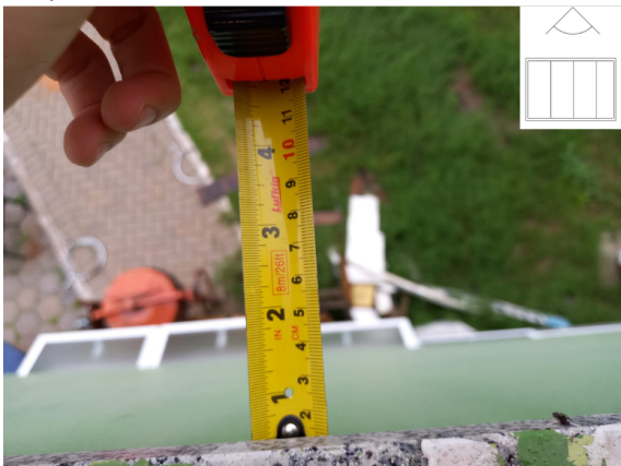
Figura 12: Prolongamento transversal do peitoril, edifício 02
