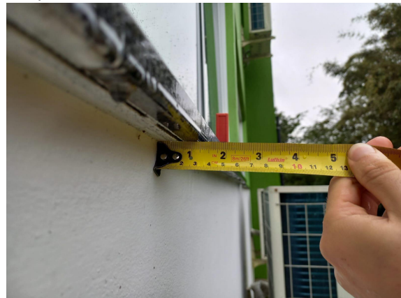
Figura 13: Prolongamento transversal do peitoril, edifício 02
