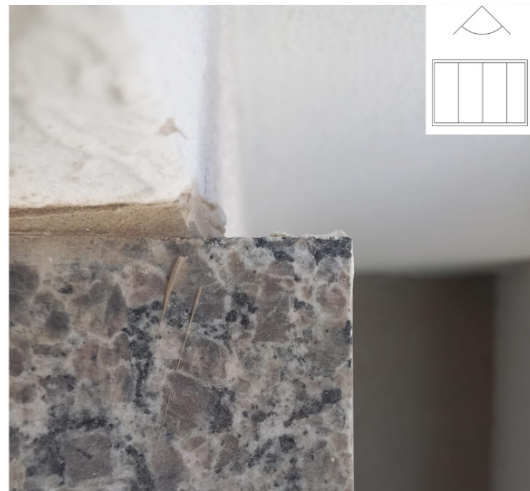
Figura 11: Prolongamento transversal do peitoril, inferior a 4cm, edifício 01
