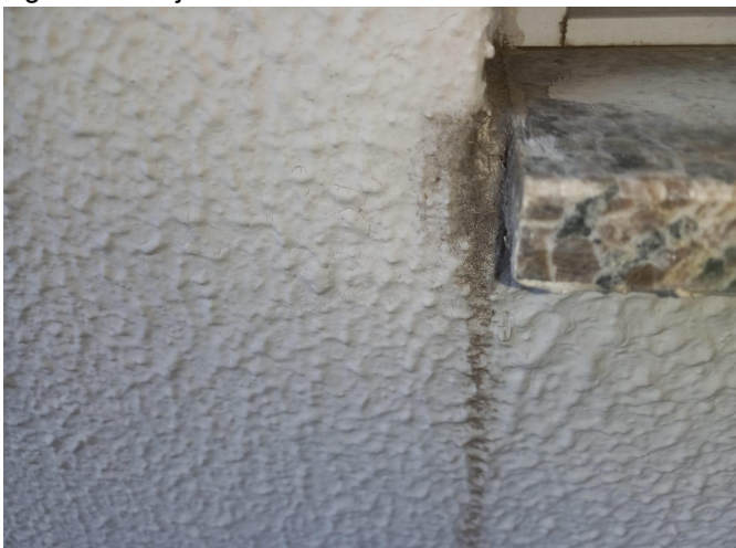
Figura 05: Sujidade na fachada do edifício 01
