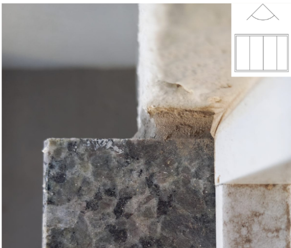
Figura 10: Ausência do prolongamento longitudinal do peitoril, edifício 01
