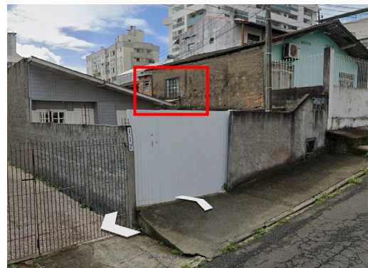
Figura 11 – Janelas construídas em desacordo com o art. 1.301 do Código Civil de 2002
