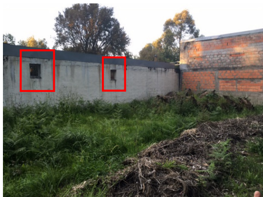
Figura 7 – Janelas edificadas na divisa
