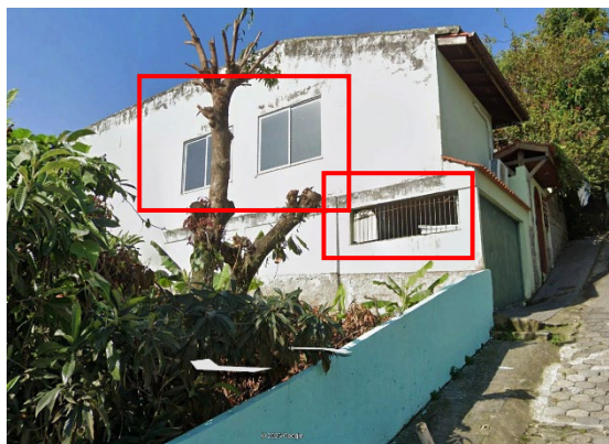
Figura 5 – Janelas edificadas na divisa
