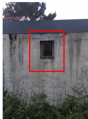
Figura 8 – Janela edificada na divisa
