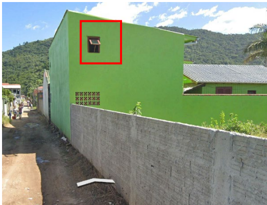
Figura 3 – Janela edificada na divisa
