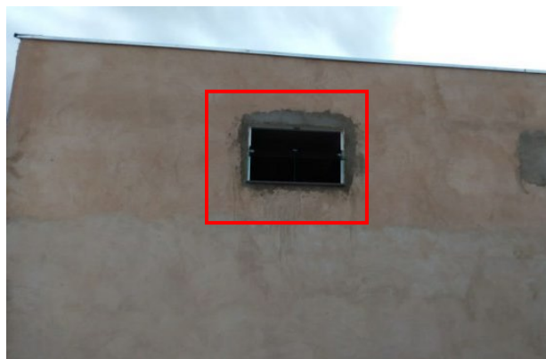
Figura 6 – Janela edificada na divisa
