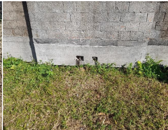
Figura 12: Conexões para sistema de esgoto
