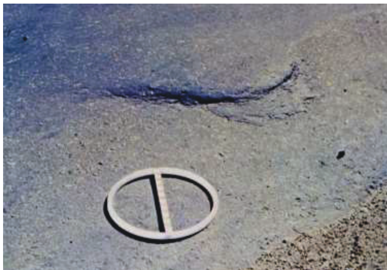
Figura 23 - Escorregamento do pavimento
