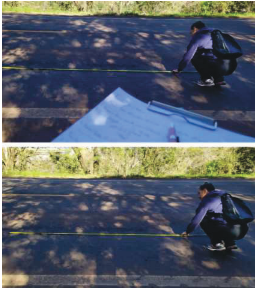
Figura 36 - Levantamento dos defeitos no pavimento
