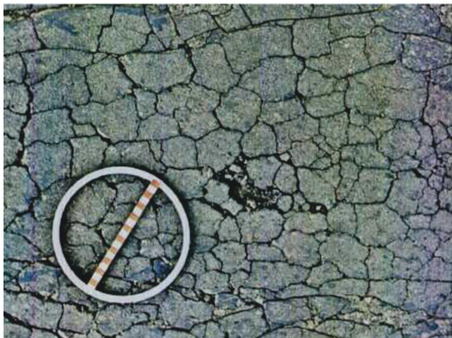
Figura 17 - Trinca Interligada – Tipo Couro de Jacaré ou por Fadiga
