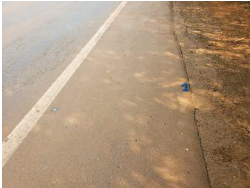
Figura 37 - Demarcação de controle dos defeitos
