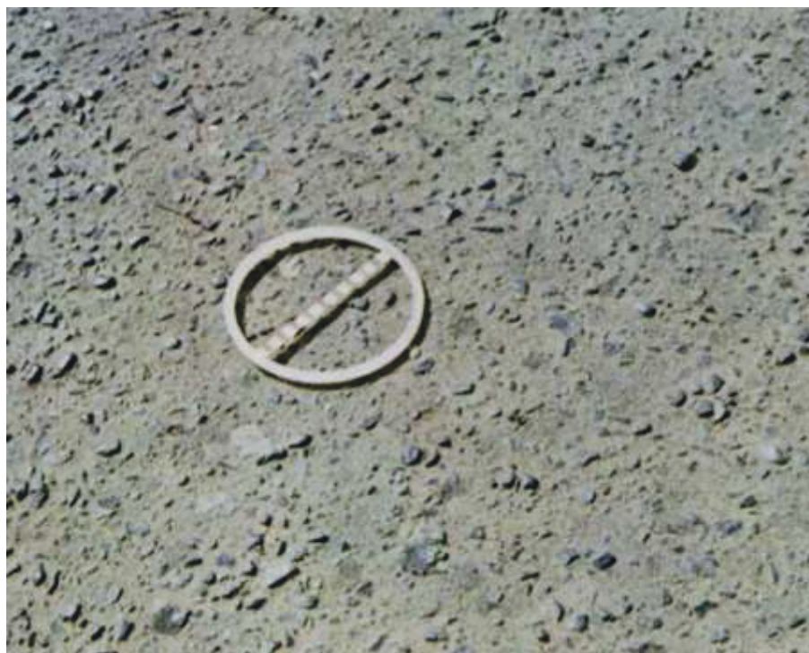
Figura 20 - Desgaste do pavimento
