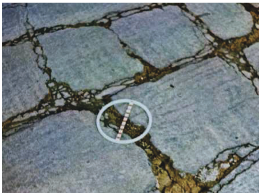
Figura 18 - Trinca Interligada – Tipo Bloco
