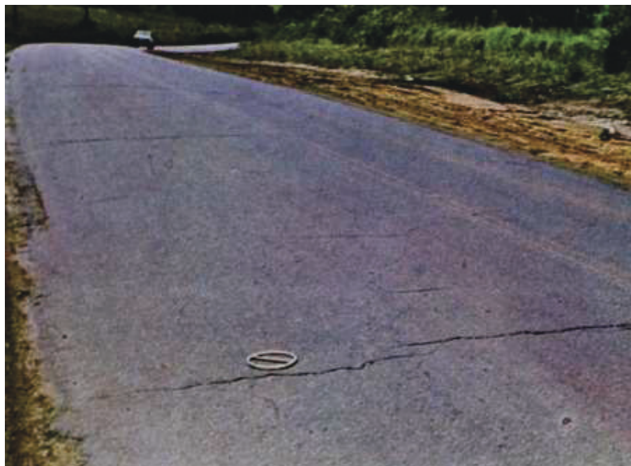
Figura 15 - Trinca Isolada Transversal
