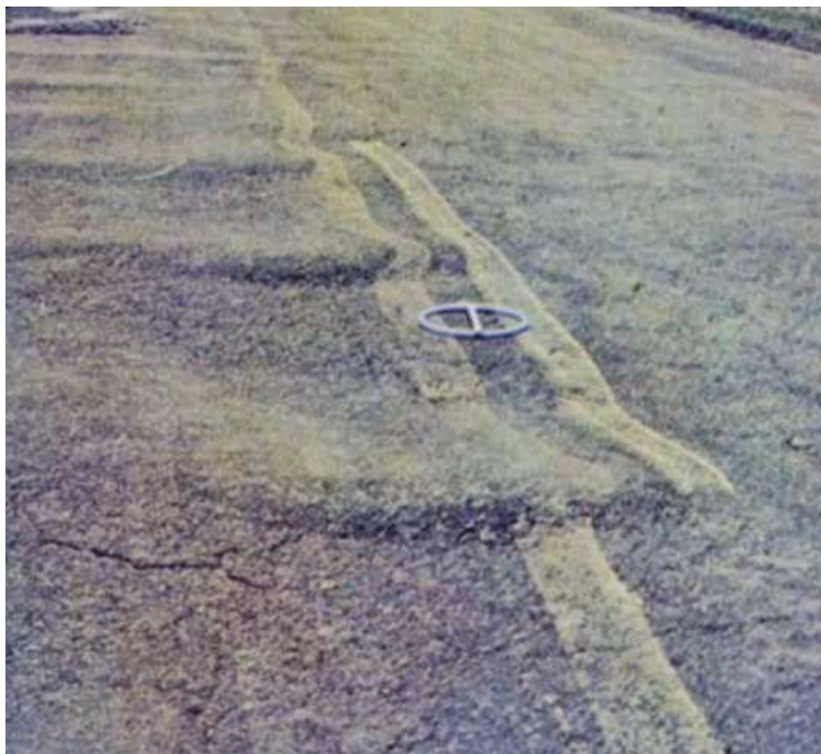
Figura 22 - Ondulação no pavimento
