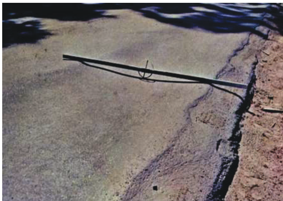
Figura 19 - Afundamento ou Deformação Permanente
