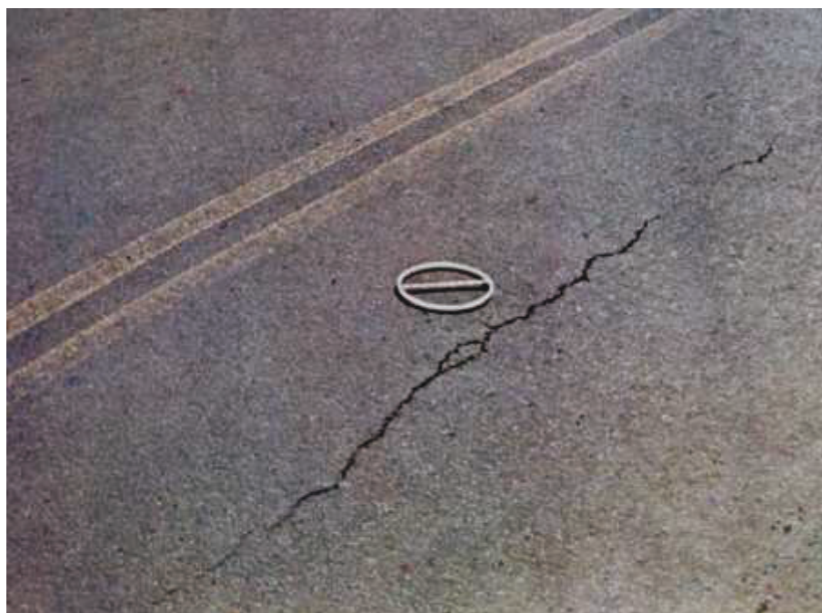
Figura 16 - Trinca Isolada Longitudinal
