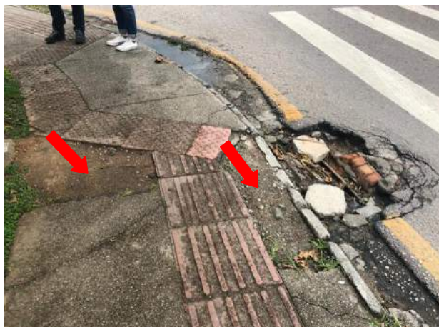
Figura 268 – Calçada danificada na Praça 19.04
