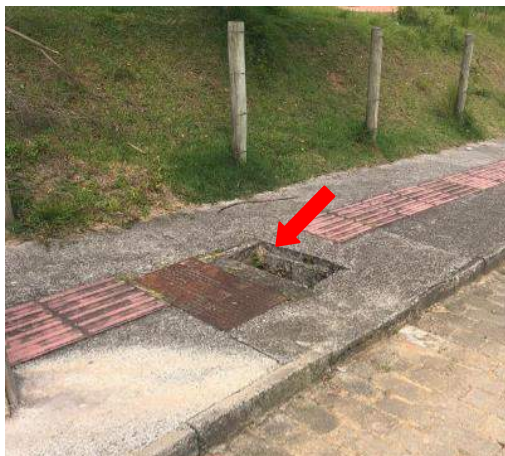
Figura 262 – Ausência de tampa na calçada da Praça 1.04
