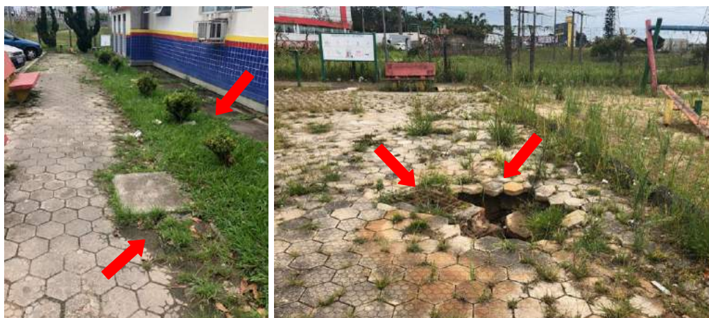
Figura 275 – Ausência de sarjeta e passeio interno danificado da Praça 19.02
