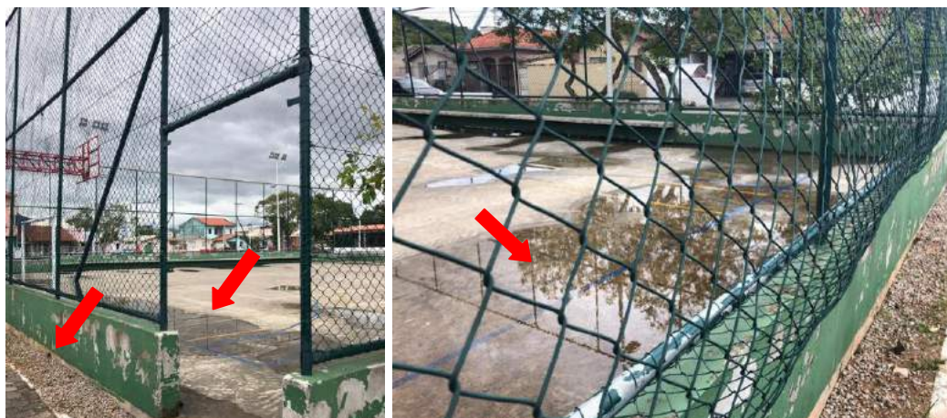
Figura 273 – Acúmulo de água na quadra de esportes da praça 10.01
