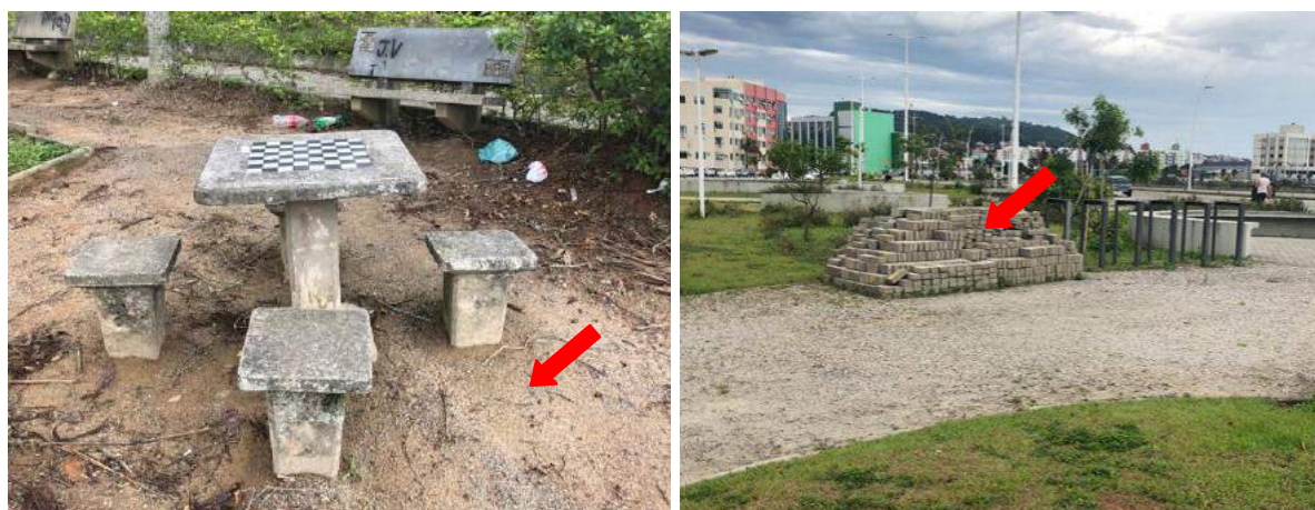
Figura 354 – Passeio interno: ausência de pavimentação na Praça 8.02 e colocação incompleta de paver na praça 18.01, respectivamente
