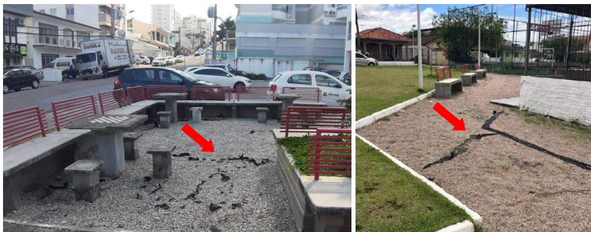
Figura 349 – Passeio interno: deslocamento da manta geotêxtil nas Praças 2.01 e 10.01 respectivamente
