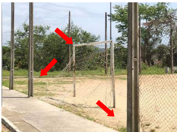
Figura 441 – Campo de futebol: improviso na sustentação da rede da trave devido a ausência de barras; tela do alambrado danificada na Praça 20.05
