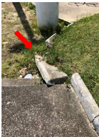
Figura 301 – Meio-fio danificado na Praça 20.12
