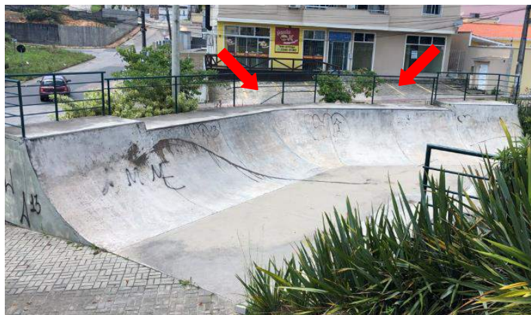
Figura 362 – Pista de skate: guarda-corpo danificado na Praça 20.11
