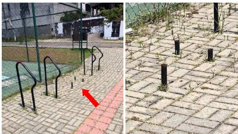
Figura 409 – Bicletário: danificado com sobra de elemento cortante na Praça 20.11
