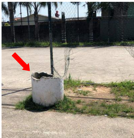
Figura 298 – Lixeira danificada na Praça 20.12
