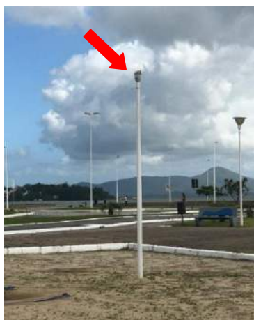
Figura 283 – Poste com refletor danificado na Praça 4.02
