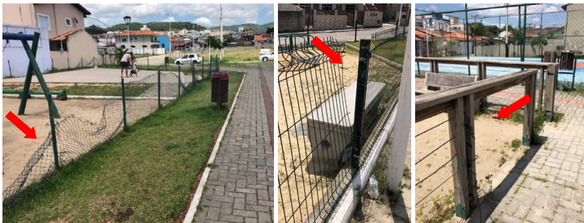
Figura 339 – Parque infantil: fechamento perimetral danificado nas Praças 9.03, 20.01 e 20.11 respectivamente
