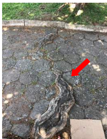
Figura 404 – Vegetação arbórea: passeio interno danificado por raiz de árvore de grande porte na Praça 20.08
