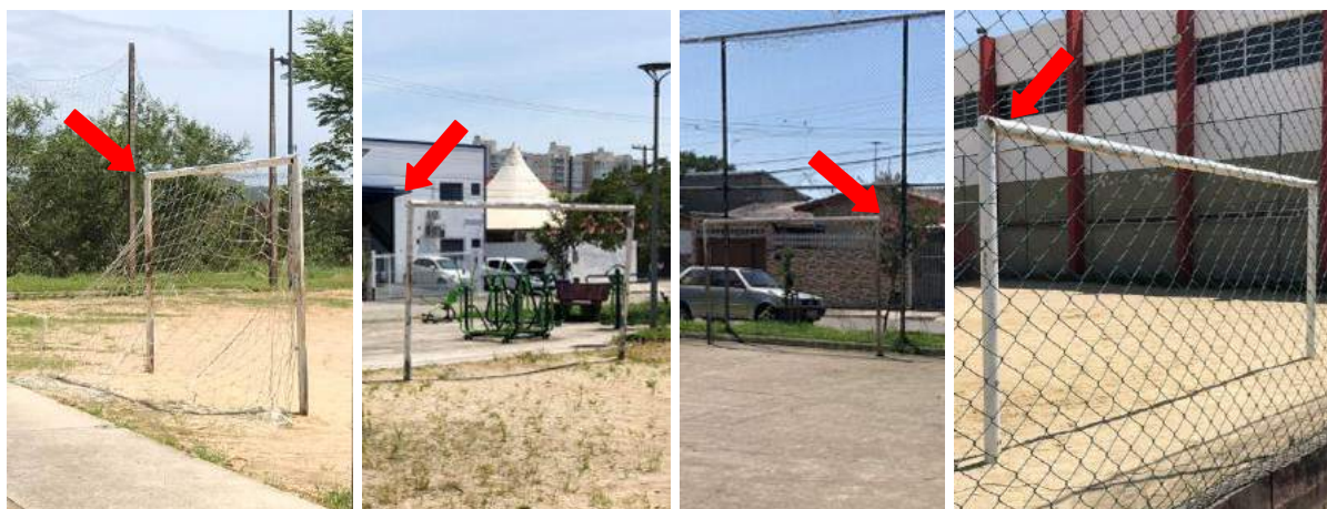
Figura 387 – Quadra de esportes: traves de futebol sem as barras de sustentação da rede - Praças 20.05, 20.08, 20.12 e 20.14 respectivamente
