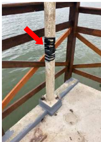
Figura 286 – Poste de iluminação com isolamento inadequado ao acesso à parte elétrica da Praça 16.03
