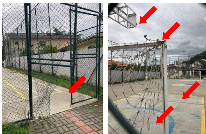
Figura 431 – Quadra de esportes: ausência de tabelas e cestas de basquete; ausência de barras de sustentação da rede das traves de futebol; redes danificadas nas traves de futebol; e ausência de pintura no piso na Praça 10.06
