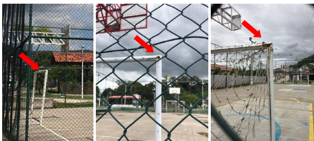
Figura 385 – Quadra de esportes: traves de futebol sem as barras de sustentação da rede- Praças 9.03, 10.01 e 10.06 respectivamente
