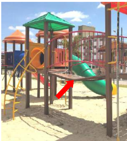
Figura 345 – Parque infantil: piso danificado no acesso entre torres do playground da Praça 20.01
