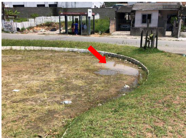
Figura 278 – Acúmulo de água na Praça 20.12
