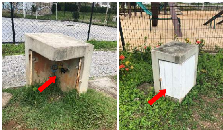
Figura 241 - Alimentação de água na Praça 18.01
