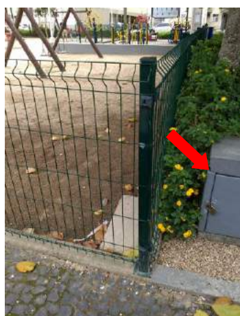
Figura 238 - Alimentação de água na Praça 12.03
