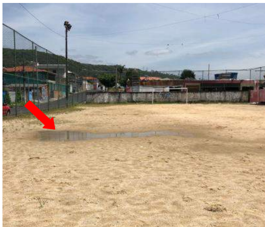
Figura 279 – Acúmulo de água na quadra de esportes da Praça 20.14
