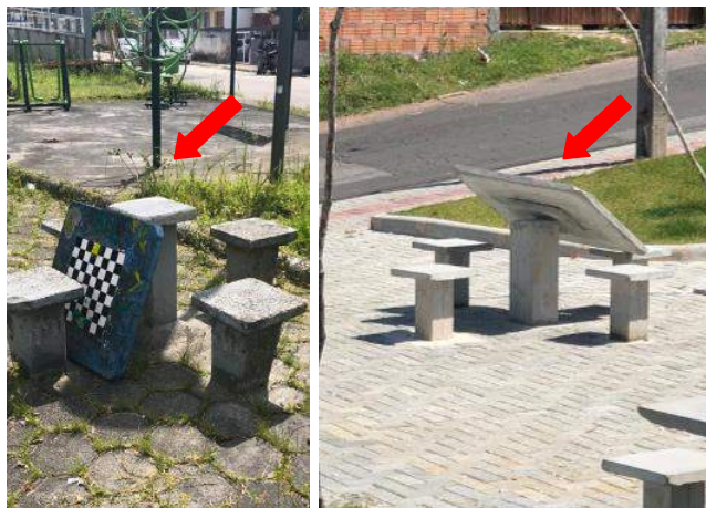
Figura 307 – Mobiliário: tampos de mesas deslocados nas Praças 1.03, 20.02 respectivamente
