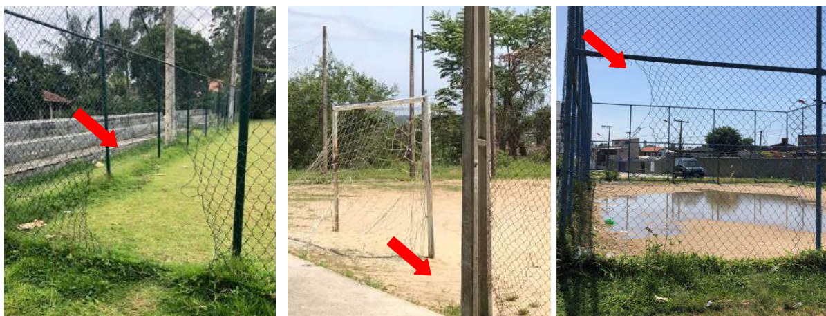
Figura 382 – Quadra de esportes: tela do alambrado danificada - Praças 17.03, 20.05 e 20.10 respectivamente
