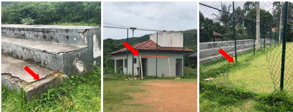
Figura 440 – Campo de futebol: reboco da arquibancada em processo de deslocamento; traves de madeira improvisadas; e tela do alambrado danificada na Praça 17.03
