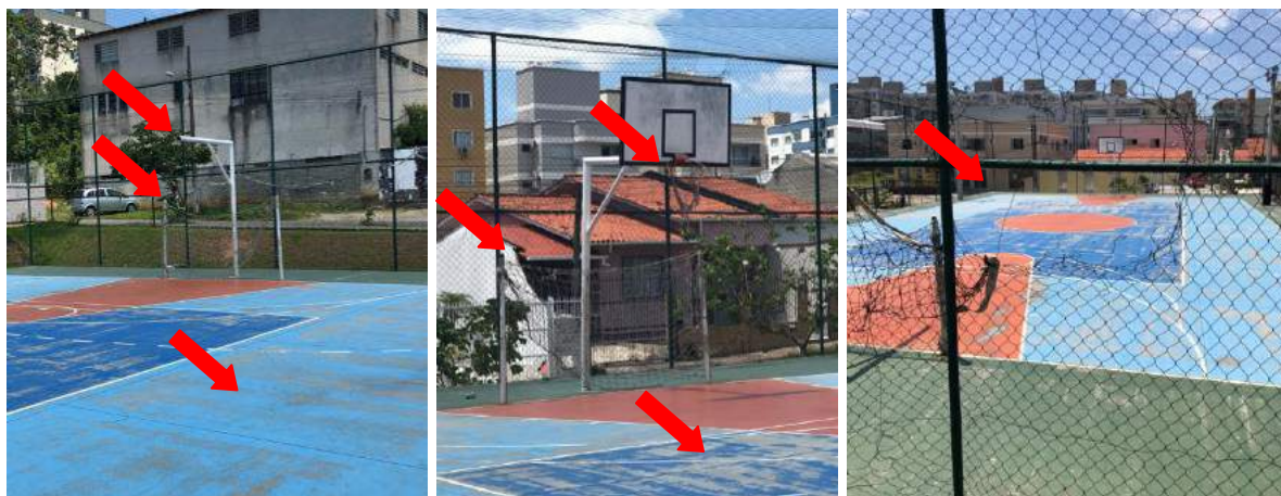
Figura 430 – Quadra de esportes da Praça 20.11: tabelas de basquete, traves de futebol e tela do alambrado danificados; piso com necessidade de repintura
