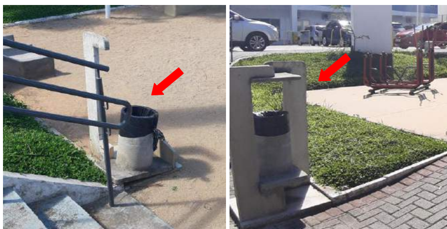
Figura 297 – Lixeira de concreto danificada na Praça 2.01 e perfeita na Praça 2.01 respectivamente
