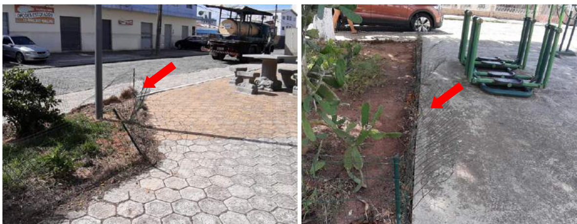
Figura 318 – Paisagismo: cerca para jardim danificada na Praça 2.02
