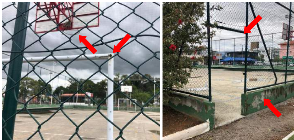
Figura 438 – Ausência de rede da cesta de basquete, elementos da trave de futebol e portão de acesso na Praça 10.01
