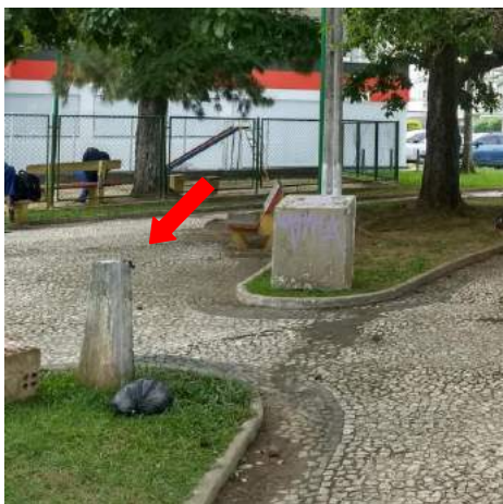
Figura 239 - Alimentação de água na Praça 12.10
