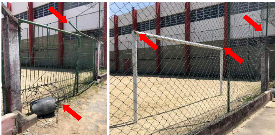
Figura 446 – Campo de futebol: portão de acesso danificado; ausência de barras de sustentação da rede nas traves e a própria rede; tela do alambrado danificada na Praça 20.14
