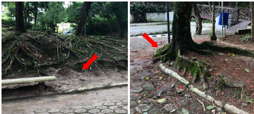
Figura 264 – Presença de árvores e raízes no alinhamento da calçada da Praça 5.06
