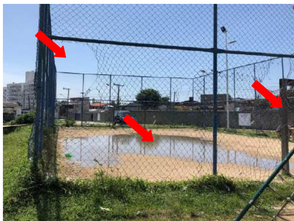
Figura 444 – Campo de futebol: trave sem rede e barras de sustentação da mesma; tela do alambrado danificada; acúmulo de água na Praça 20.10
