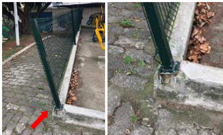
Figura 412 - Guarda-corpo: estrutura comprometida na Praça 11.02
