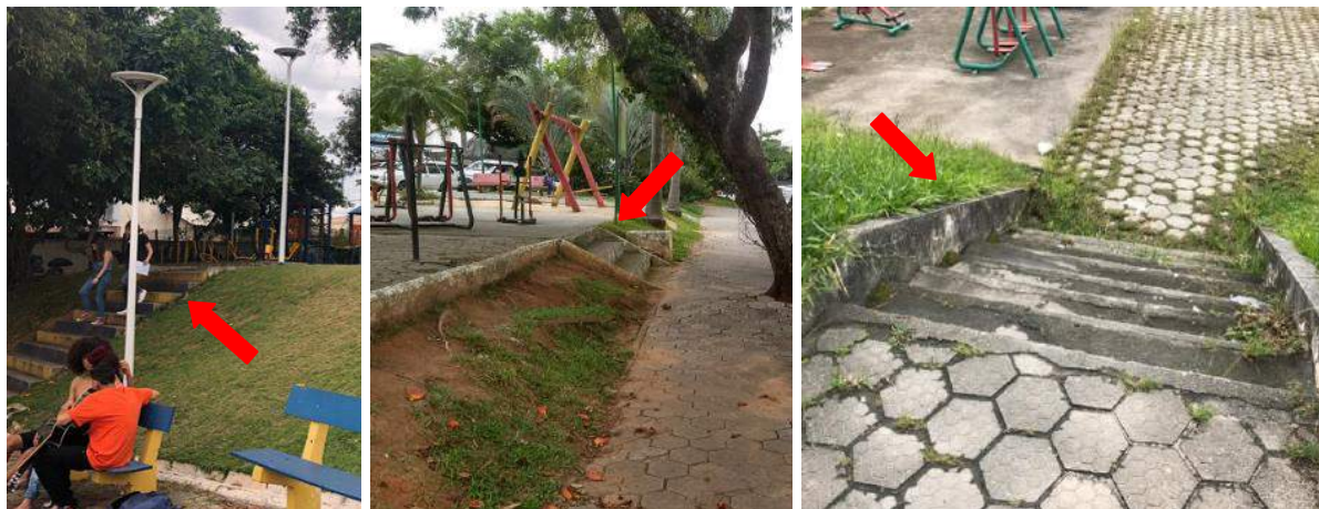
Figura 217 – Ausência de corrimão nas Praças 11.02, 12.01 e 19.02 (respectivamente)
