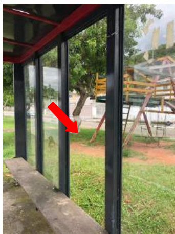
Figura 377 – Ponto de ônibus: ausência de vidro no abrigo da Praça 10.03
