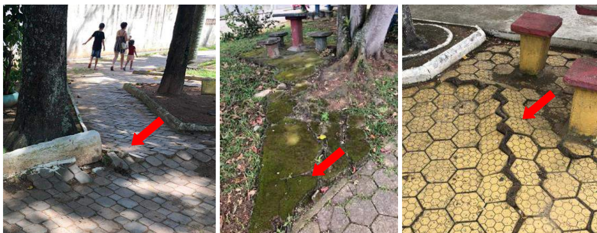
Figura 403 – Vegetação arbórea: passeio interno danificado pelas raízes de árvores de grande porte nas Praças 3.01, 8.03 e 11.03 respectivamente
