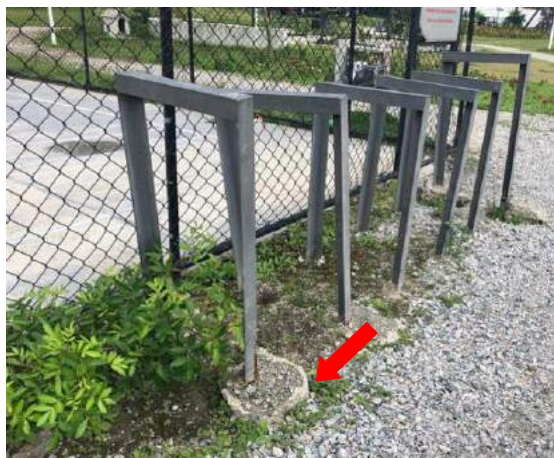
Figura 408 – Bicletário: sapatas deslocadas e estrutura enferrujada na Praça 18.01
