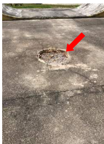
Figura 361 – Pista de skate: piso danificado na Praça 20.08
