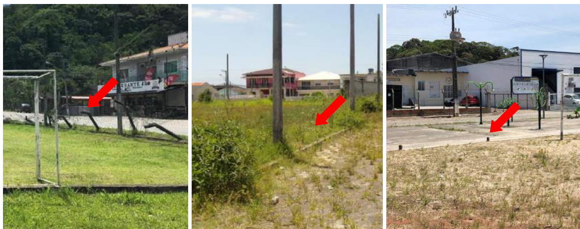
Figura 384 – Quadra de esportes: alambrado danificado - Praças 6.01, 20.07 e 20.08
