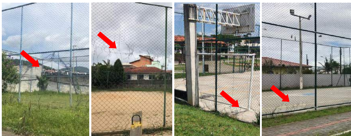
Figura 381 – Quadra de esportes: tela do alambrado danificada - Praças 1.03, 8.03, 9.03 e 10.06 respectivamente
