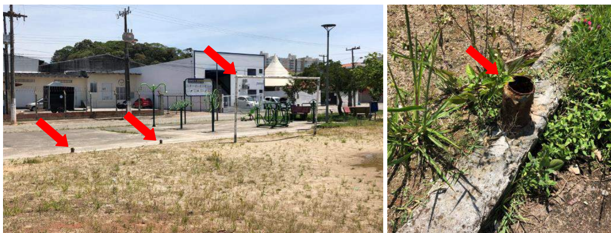
Figura 443 – Campo de futebol: traves sem barras de sustentação da rede; ausência de rede da trave e alambrado; sobra de tubos cortantes de antiga estrutura na Praça 20.08
