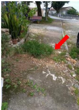
Figura 266 – Calçada danificada na Praça 16.01
