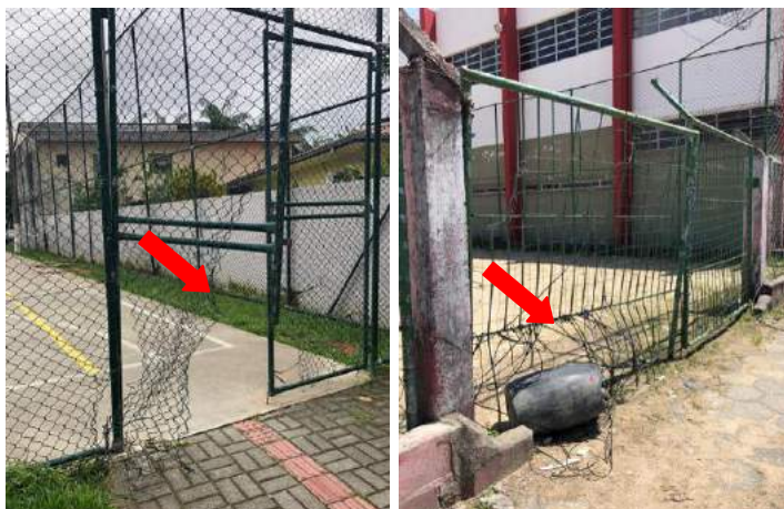
Figura 393 – Quadra de esportes: portão de acesso danificado - Praças 10.06 e 20.14 respectivamente
