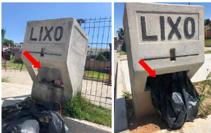
Figura 294 – Lixeiras danificadas na Praça 20.02
