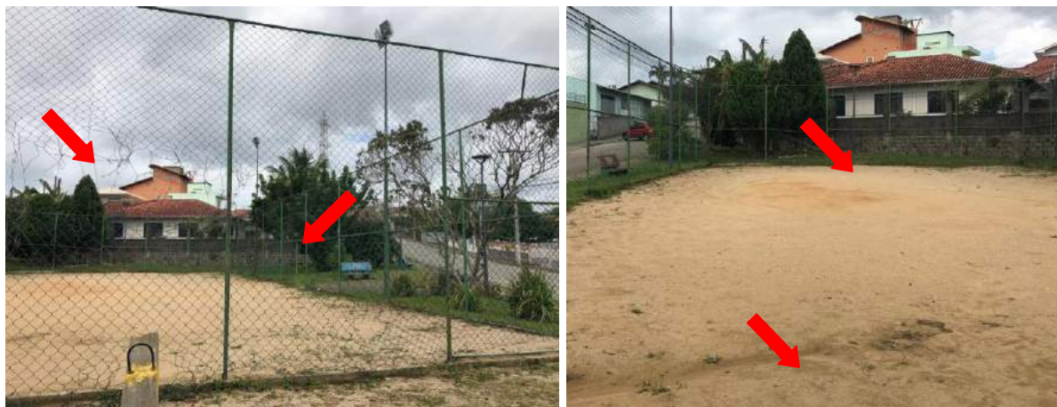
Figura 434 – Tela do alambrado danificada e ausência de portão e traves no campo de futebol da Praça 8.03
