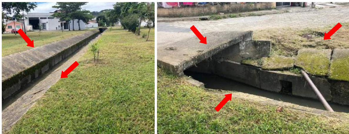
Figura 411 – Guarda-corpo: ausência no canal de drenagem da Praça 10.04
