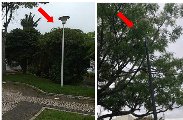
Figura 285 – Poste com luminária no padrão antigo situado nas Praças 4.01 e 10.05 respectivamente
