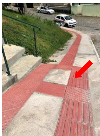
Figura 214 - Acessibilidade prejudicada no acesso à Praça 3.03
