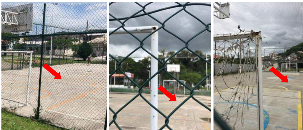
Figura 390 – Quadra de esportes: ausência de pintura no piso - Praças 9.03, 10.01 e 10.06 respectivamente
