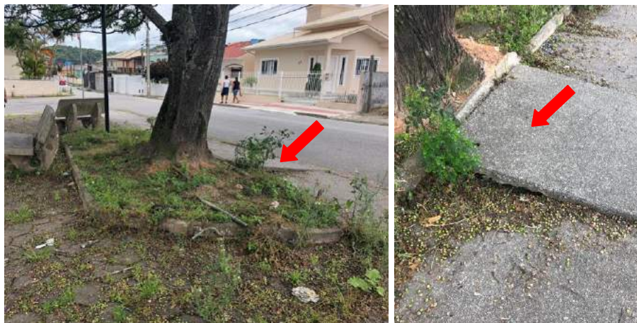
Figura 405 – Vegetação arbórea: calçada danificada pela raiz de árvore de grande porte na Praça 10.05
