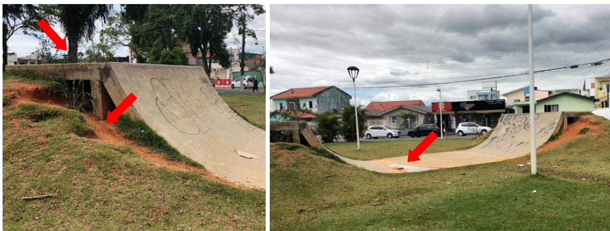
Figura 360 – Pista de skate: ausência de estrutura para acessar as plataformas, guarda-corpo e sistema de drenagem na Praça 10.01
