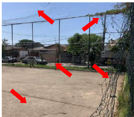
Figura 445 – Quadra de esportes: tela do alambrado danificada com presença de vegetação; piso em concreto não alisado e sem pintura; traves sem barras de sustentação da rede; ausência de rede nas traves na Praça 20.12
