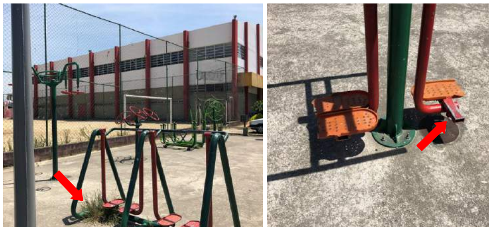
Figura 208 - Equipamento danificado na academia da Praça 20.14
