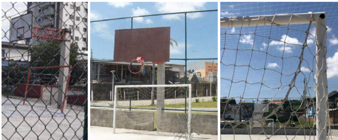
Figura 386 – Quadra de esportes: traves de futebol sem as barras de sustentação da rede - Praças 13.02, 20.01 e 20.02 respectivamente
