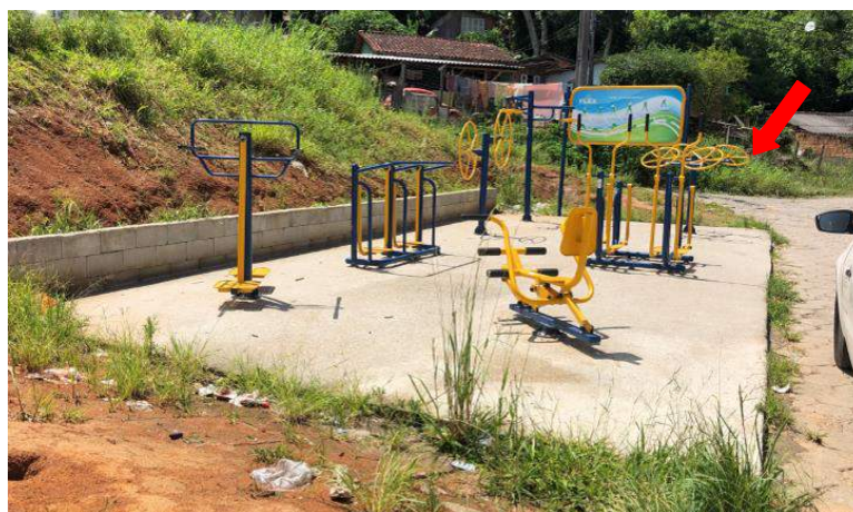
Figura 269 – Equipamento de academia localizado muito próximo da via (Praça 20.09)
