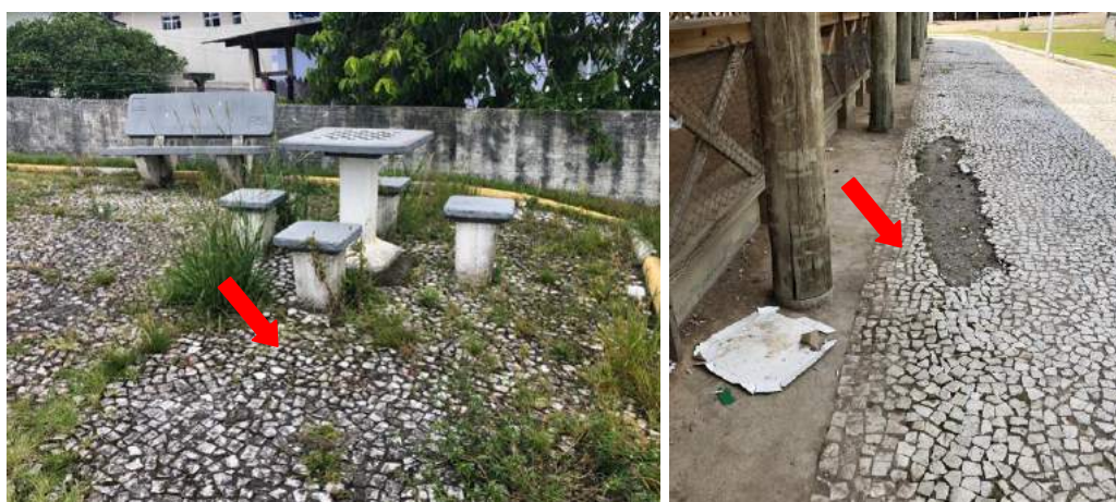
Figura 352 - Passeio interno: pedras petit-pavé com excesso de material orgânico e com ausência de pedras (Praças 11.04 e 20.01 respectivamente)
