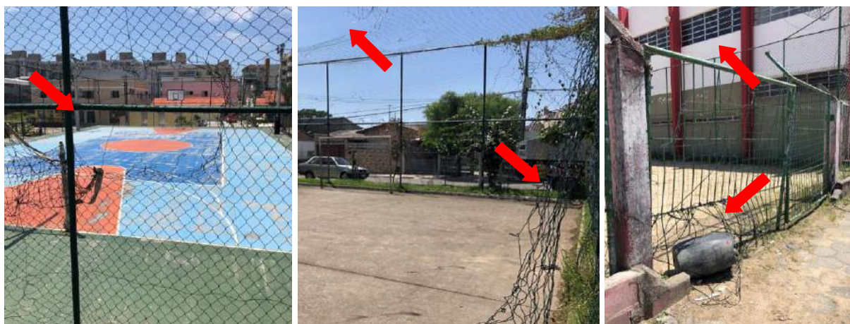
Figura 383 – Quadra de esportes: tela do alambrado danificada - Praças 20.11, 20.12 e 20.14 respectivamente
