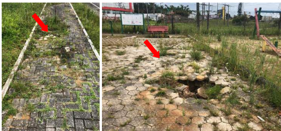
Figura 355 – Passeio interno: danificado e com excesso de vegetação nas Praças 17.01 e 19.02 respectivamente
