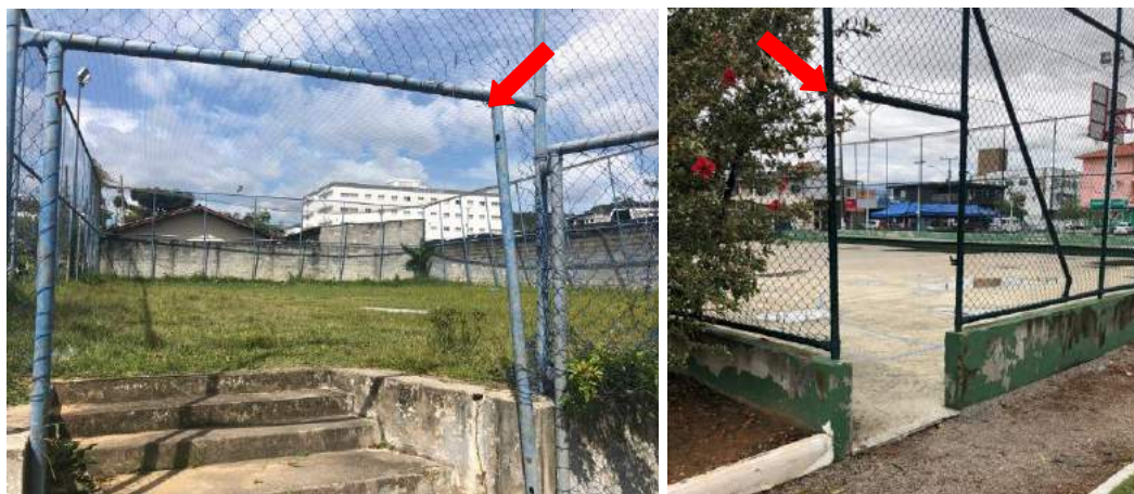
Figura 392 – Quadra de esportes: portão de acesso ausente - Praças 1.03 e 10.01 respectivamente
