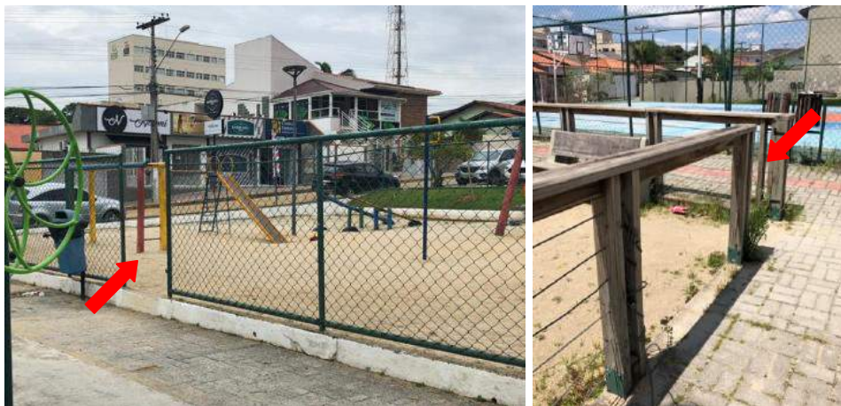
Figura 343 – Parque infantil: ausência de portão nas Praças 11.03 e 20.11
