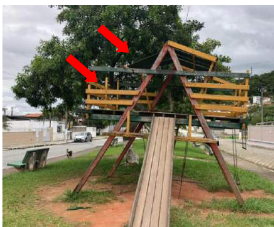
Figura 342 – Parque infantil: ausência de fechamento perimetral, parte do guarda-corpo e telhado de playground na Praça 10.03
