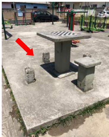
Figura 315 – Mobiliário: bancos danificados com exposição de armadura na Praça 20.14
