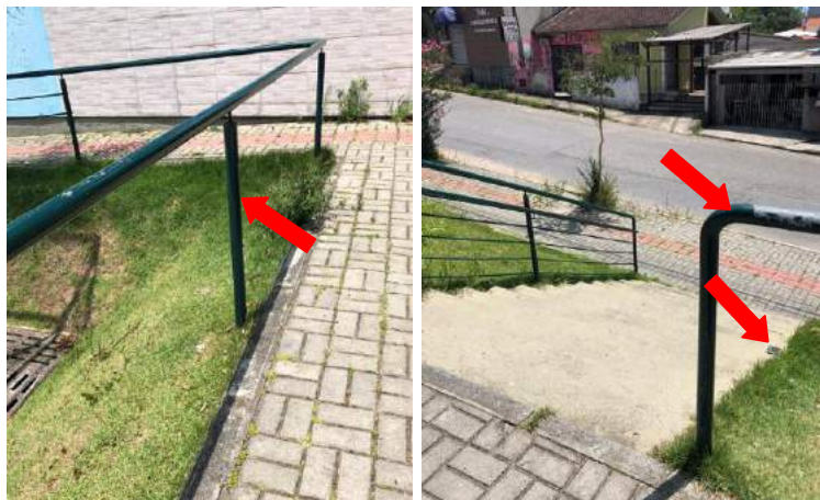
Figura 218 - Acessibilidade prejudicada no acesso à Praça 20.11
