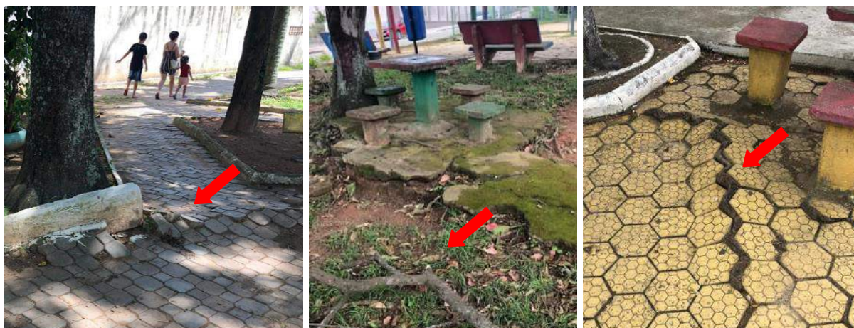
Figura 350 – Passeio interno: danificado pelas raízes de árvore nas Praças 3.01, 8.03 e 11.03 respectivamente
