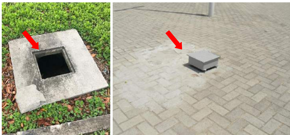
Figura 356 – Passeio interno: ausência de tampa na caixa de passagem (Praça 18.01) e caixa de energia exposta (Praça 20.01) respectivamente
