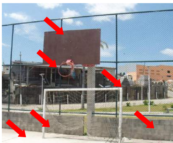
Figura 429 – Quadra de esportes: tabela de basquete sem pintura e com cesta danificada; trave de futebol sem barras de sustentação de rede; piso e mureta sem pintura na Praça 20.01
