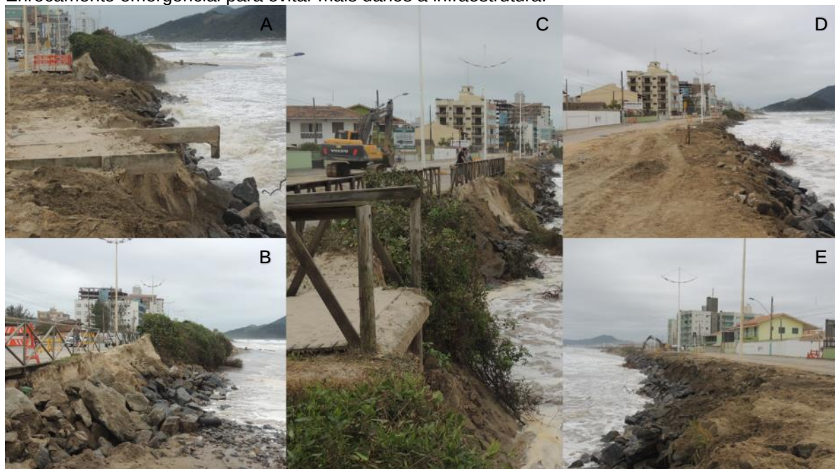
FIGURA 12 – Danos provocados pela ressaca de setembro de 2017. A e B) Danos provocados à estrutura do deck. C) Danos provocados na estreita faixa de restinga remanescente. D e E) Enrocamento emergencial para evitar mais danos à infraestrutura.
