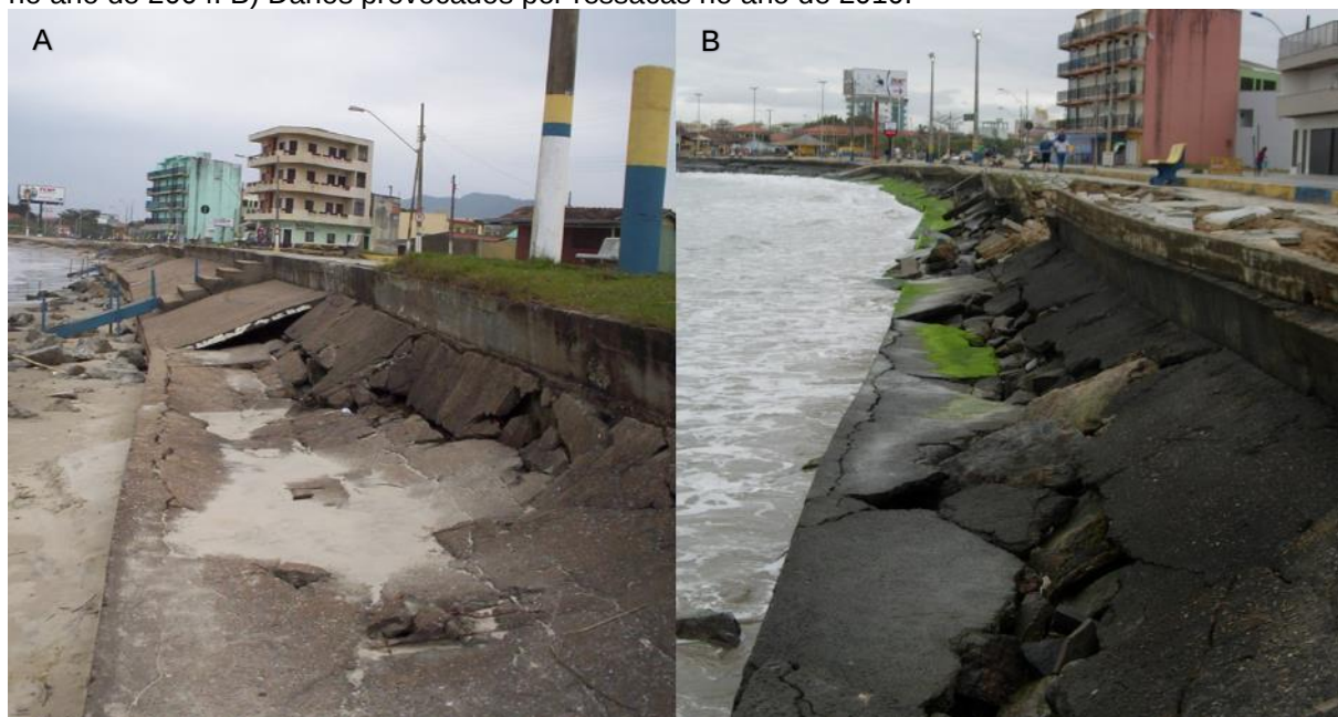
FIGURA 6 – Muro de contenção (sea wall) instalado no ano de 2003. A) Danos provocados por ressacas no ano de 2004. B) Danos provocados por ressacas no ano de 2010.
