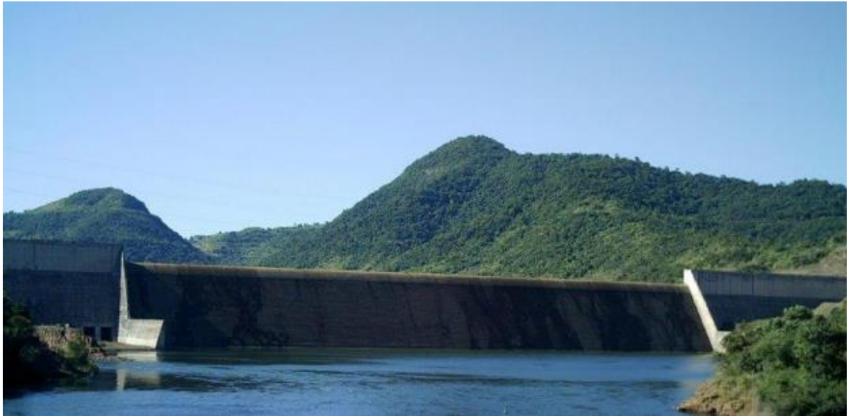
Figura 8 - Barragem de gravidade de Dona Francisca- RS
