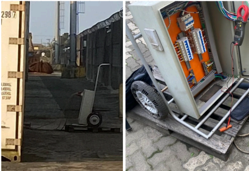
Imagem 37 – Quadro antigo das tomadas dos contêineres reefer
