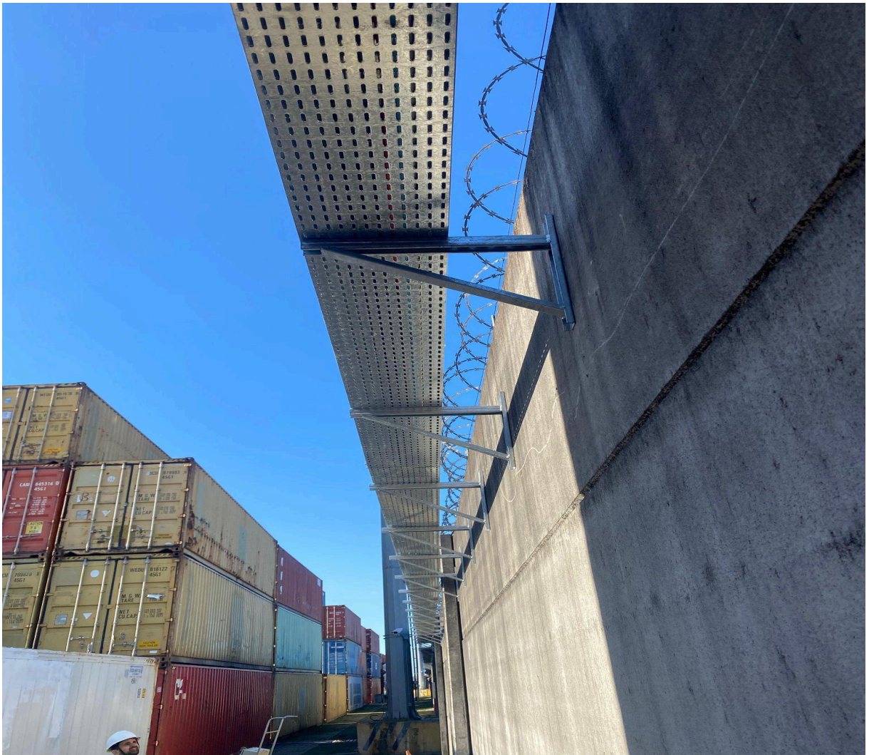
Imagem 41 – Eletrocalha fixada ao muro
