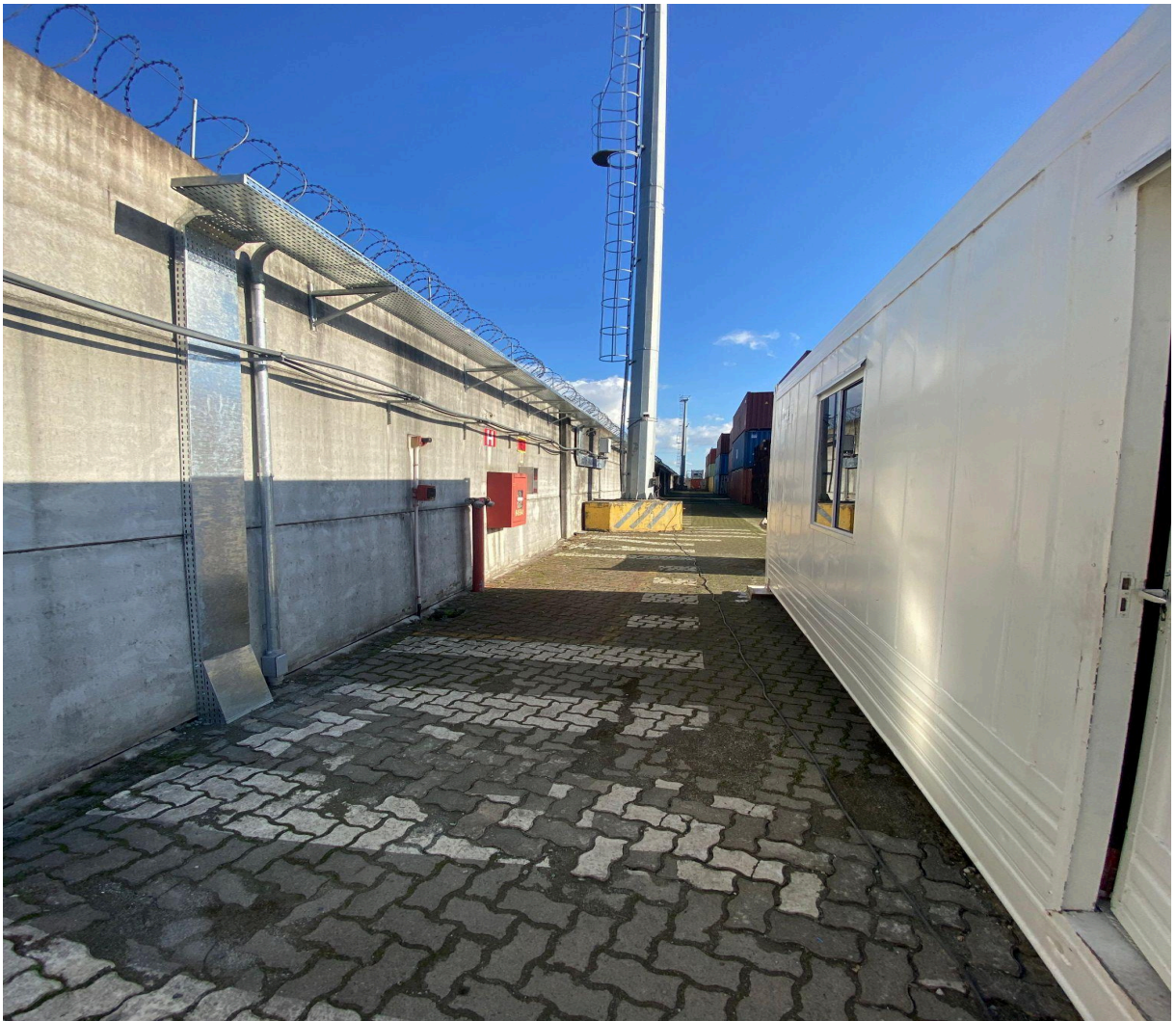
Imagem 43 – Descida eletrocalha para subterrâneo
