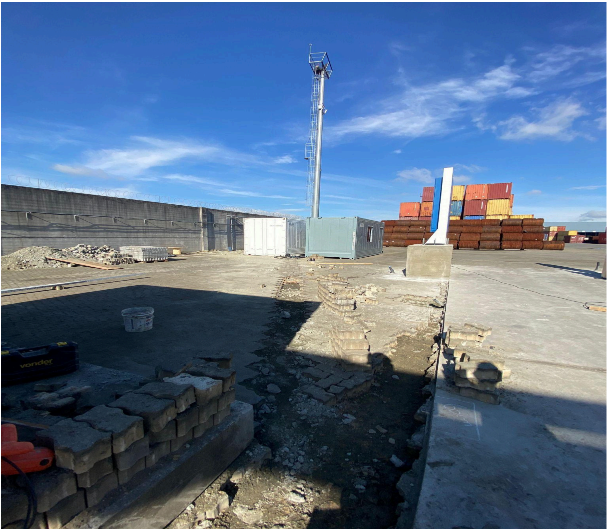
Imagem 47 – Passagem subterrânea da alimentação e lógica do scanner
