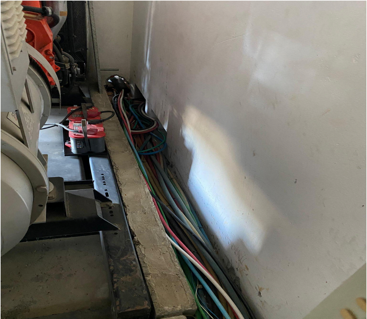
Imagem 40 – Passagem em eletrocalha no chão
