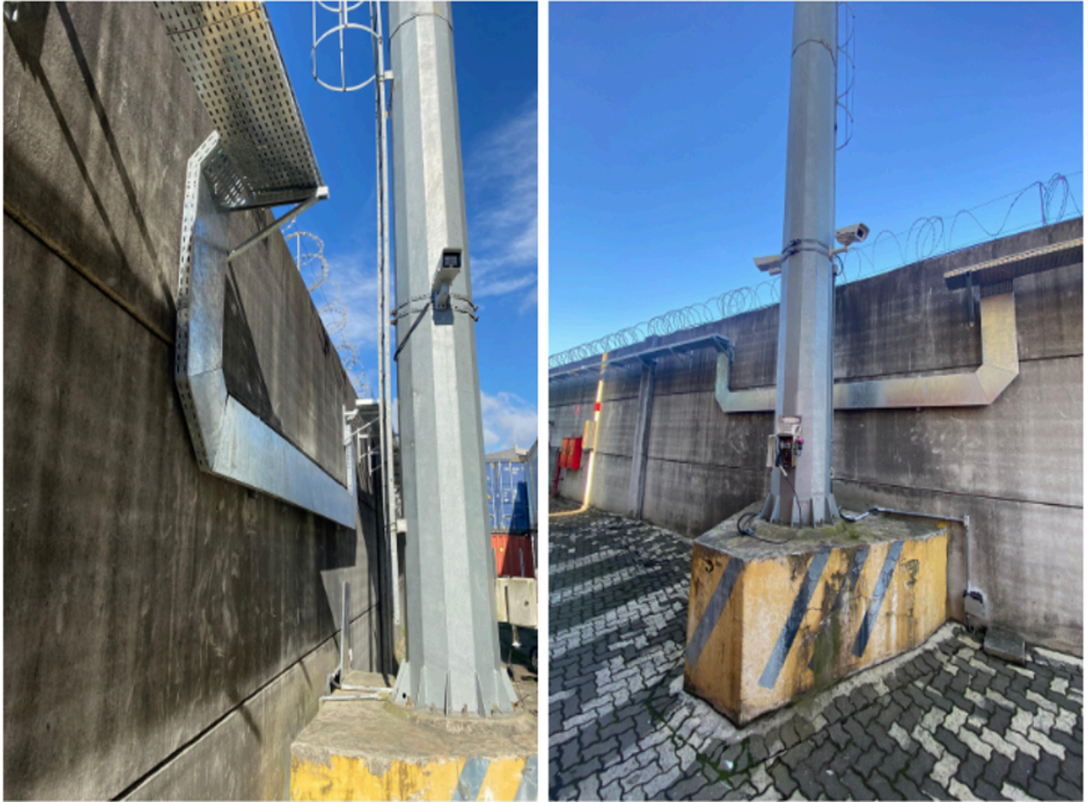
Imagem 42 – Desvio devido aos postes
