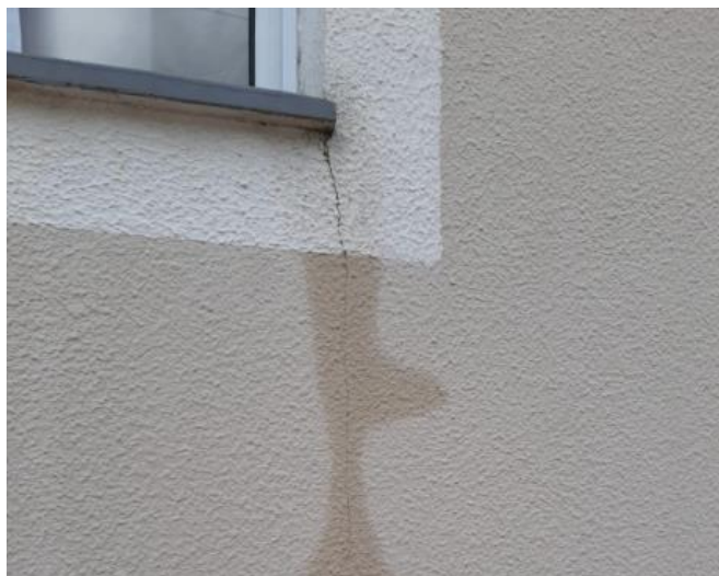
Figura 24 - Fissura a partir do canto da janela de apartamento
