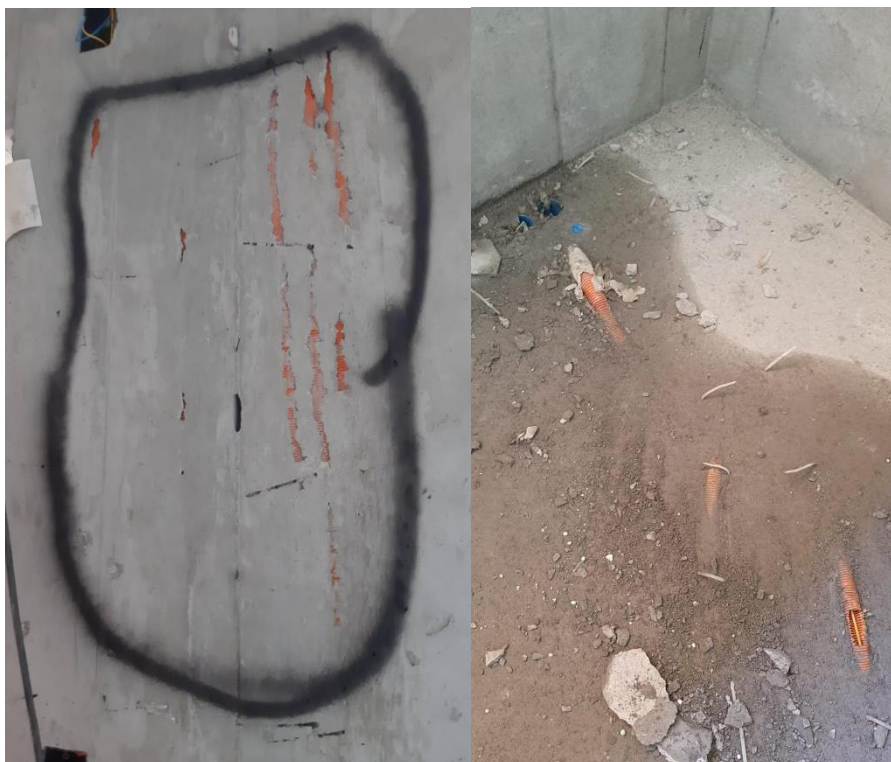
Figura 9 - Falha na concretagem com a exposição de eletrodutos em parede e laje de concreto moldada no local
