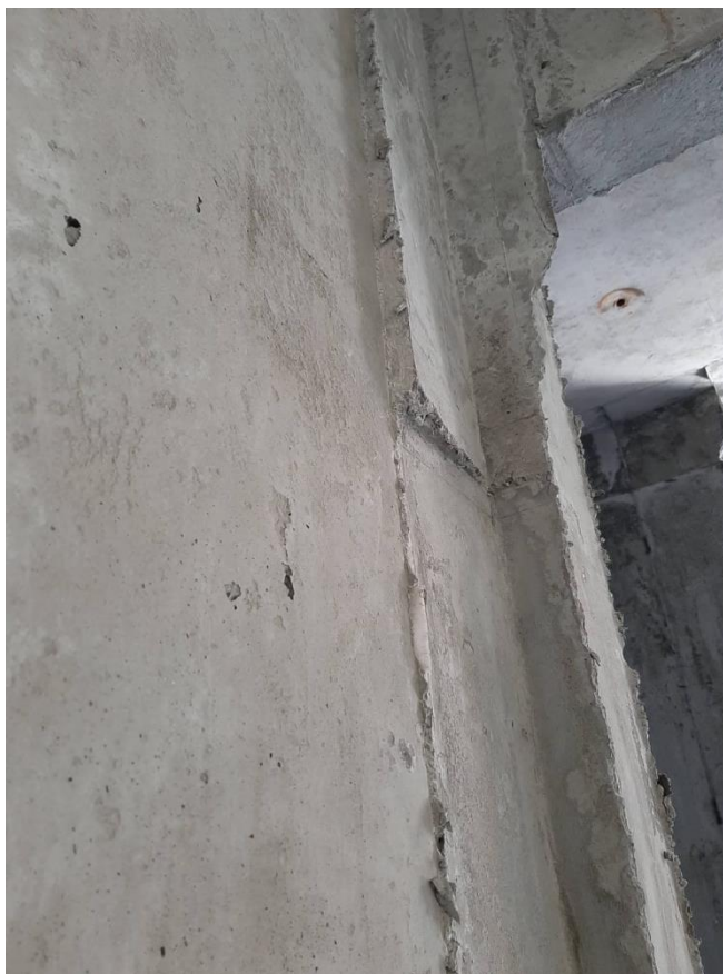
Figura 10 - Falha na parede ocasionada pela movimentação das formas durante a concretagem.
