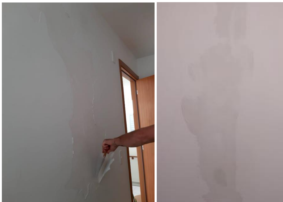
Figura 20 - Infiltração na parede da sala
