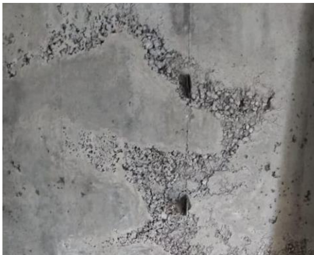
Figura 8 - Segregação de concreto em parede de concreto moldada no local
