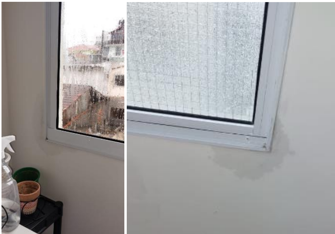
Figura 18 – Infiltrações que ocorreram nas esquadrias
