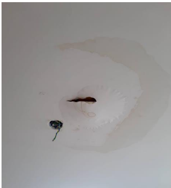
Figura 19 - Infiltração no teto do apartamento devido a falhas construtivas do telhado
