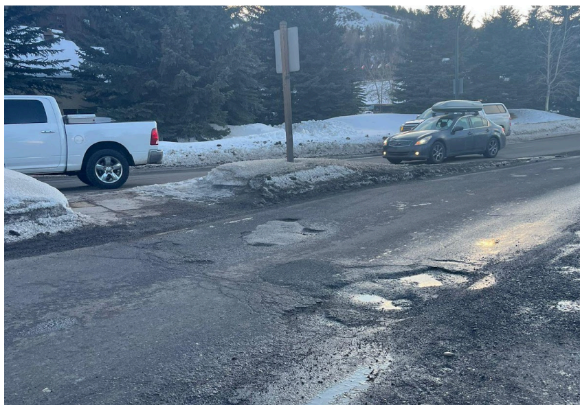
Figura 14 - Defeitos no pavimento em Avon (Colorado)
