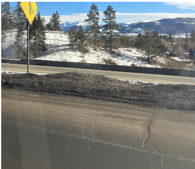
Figura 08 - Trinca térmica em pavimento na cidade de Frisco (Colorado)
