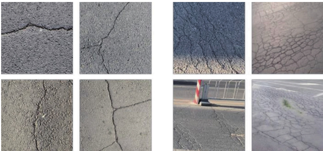
Figura 20 - Exemplos de fissuras
