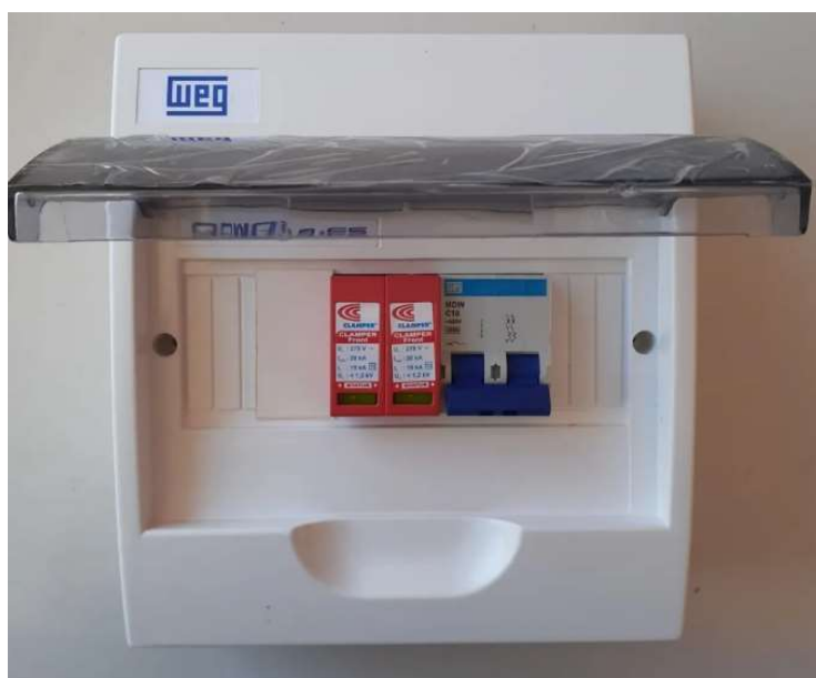
Figura 23 - Caixa de junção ( String Box )
