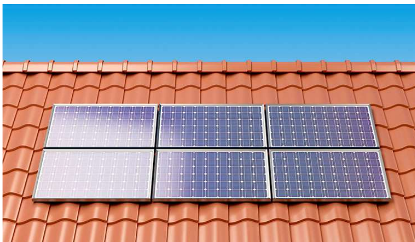
Figura 19- Módulos fotovoltaicos instalados no telhado de uma edificação
