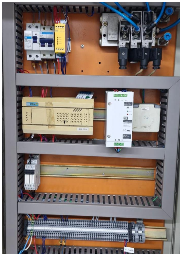
Fig. 8. Painel elétrico finalizado com sistema automatizado completo. Fonte: Autoria própria.
