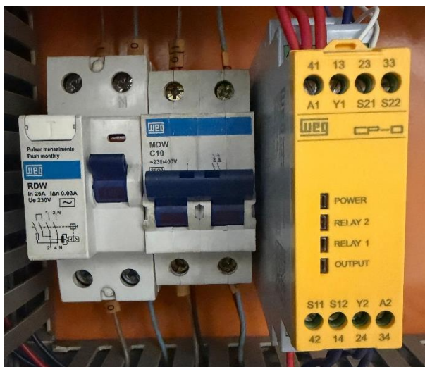
Fig. 4. Dispositivos de proteção utilizados no painel elétrico: DR, minidisjuntor e módulo de parada de emergência CP-D.
