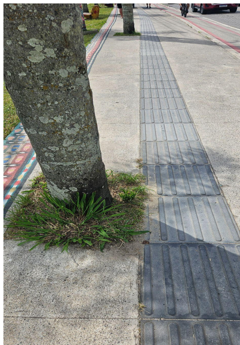
Figura 12 - Obstáculos fixos sem sinalização com piso tátil de alerta Piso tátil direcional está posicionado de forma inadequada
