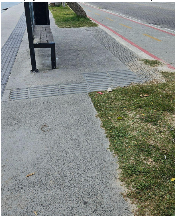
Figura 20 - Espaço não delimitado e interferindo no ponto de ônibus
