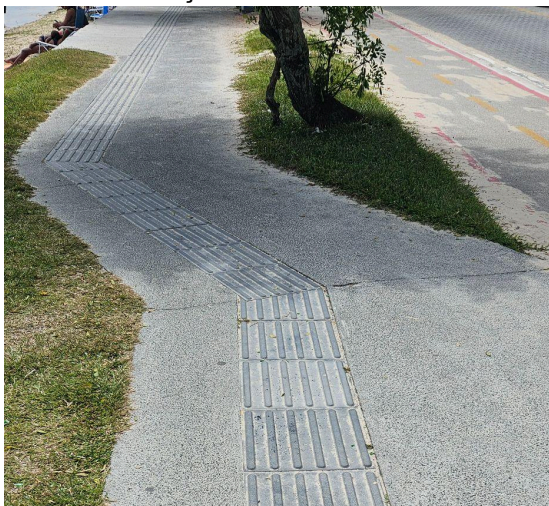
Figura 19 - Mudança de trajeto sem sinalização; Faixa de serviço não delimitada corretamente
