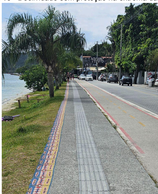
Figura 18 - Declividade sem proteção na extrema da calçada
