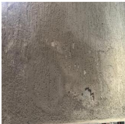
Figura 15 - Representação de deterioração da pintura
