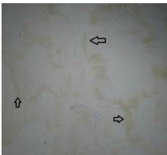
Figura 12 - Representação de manchas/infiltrações
