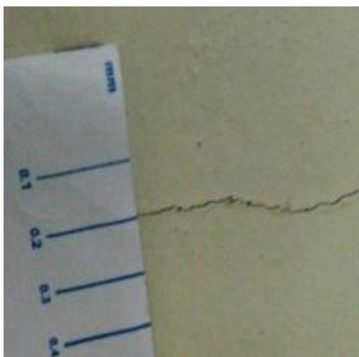
Figura 11 - Representação das fissuras em revestimento argamassado
