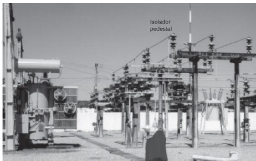
Figura 12– Isolador tipo pedestal em subestação
