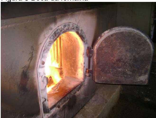
Figura 8 Boca da fornalha
