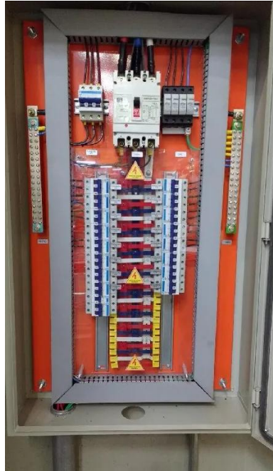
Figura 7 - Quadro Geral de Proteção
