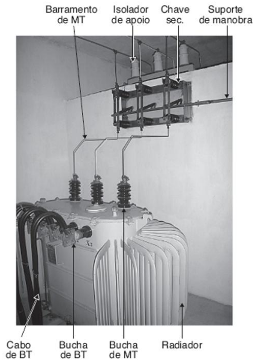
Figura 31 – Cubículo de Transformação
