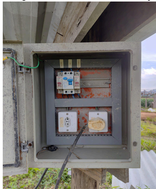
Imagem 13 - Quadro de Distribuição
