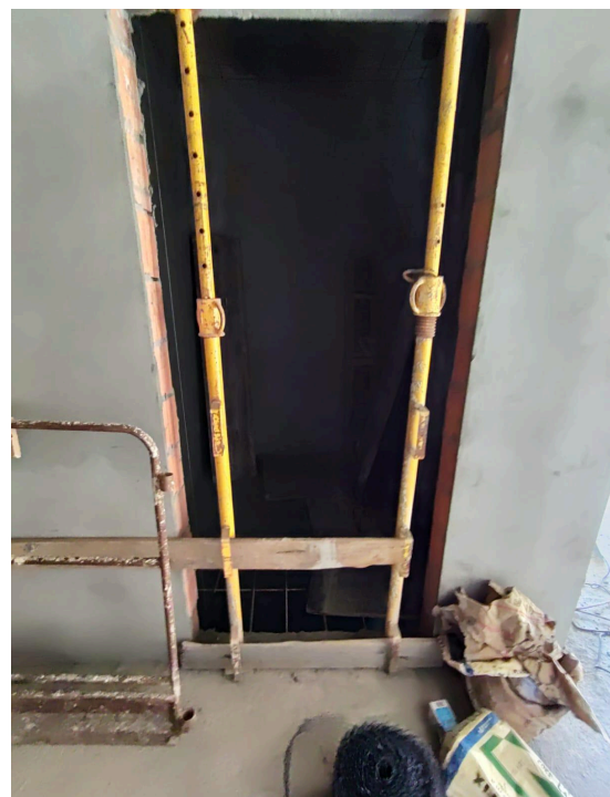
Imagem 5 - Vão sem proteção
