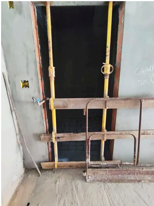
Imagem 4 - Guarda corpo sem tela
