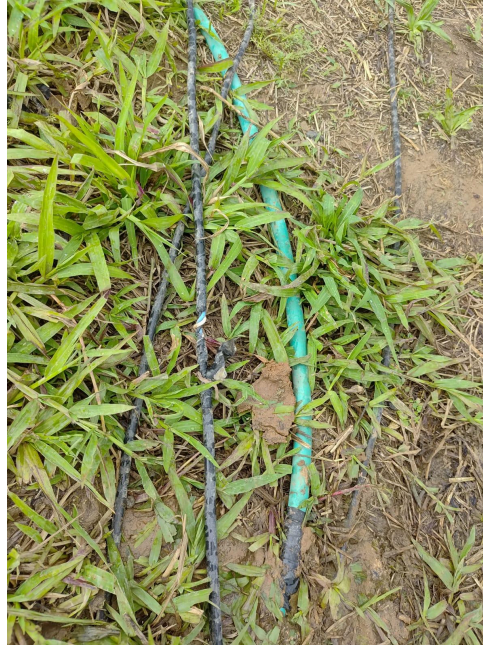
Imagem 16 - Falha no Isolamento
