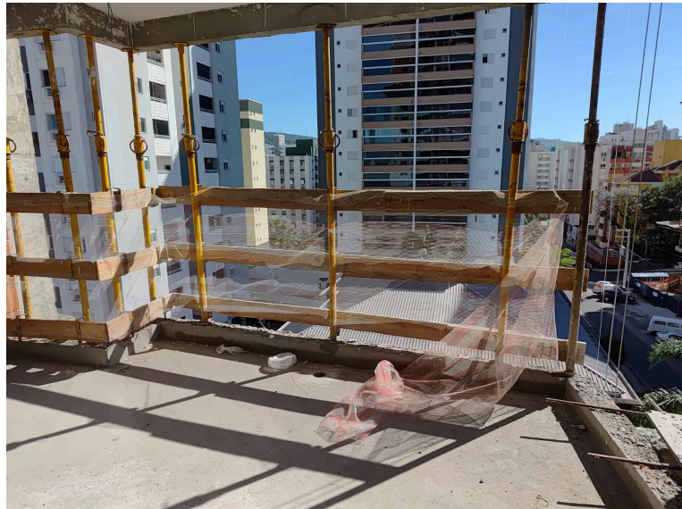
Imagem 6 - Ausência de fechamento
