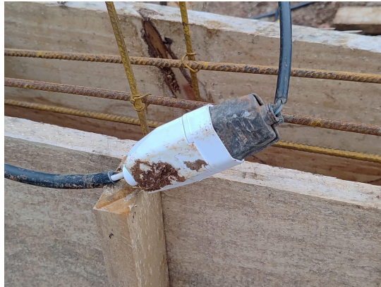
Imagem 10 - falha na isolação
