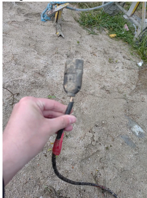
Imagem 17 - Falha no isolamento
